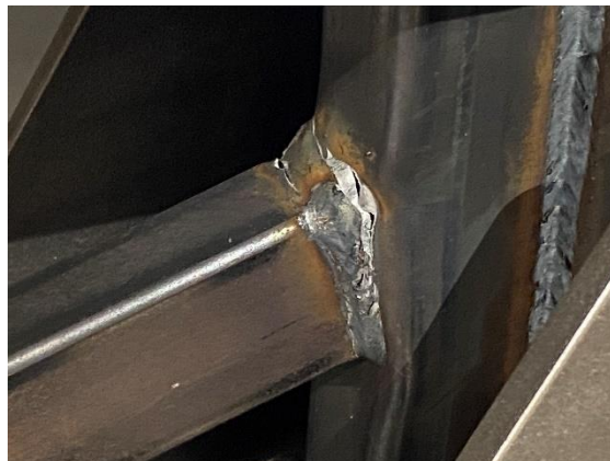
Figura 65-Fissura pormenorizada (Ensaio de flexão com junta não instrumentada)
