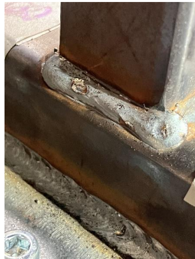
Figura 60-União soldada com fissura (Ensaio de tração)
