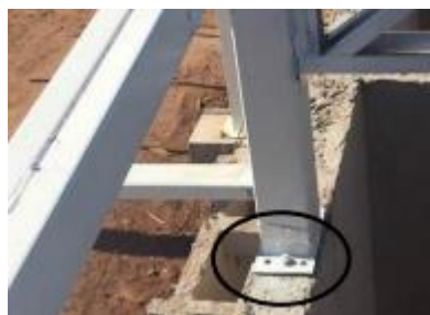
b) Desalinhamento da furação
