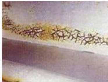
a) Fissuração ou Fendilhamento
