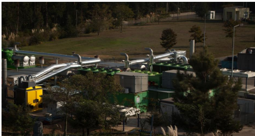
Figura 6.3 – Central de valorização energética do biogás de Sermonde
