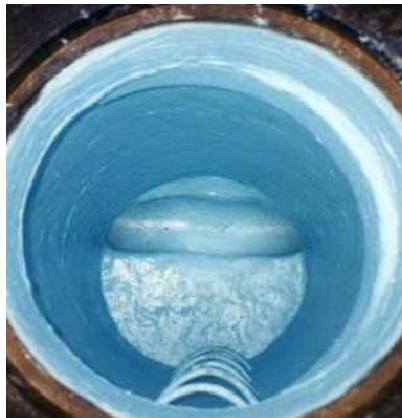
Figura 54 – Exemplo de câmara de visita rehabilitada utilizando uma película de epoxy aplicada por projecção (EPA, 2010).
