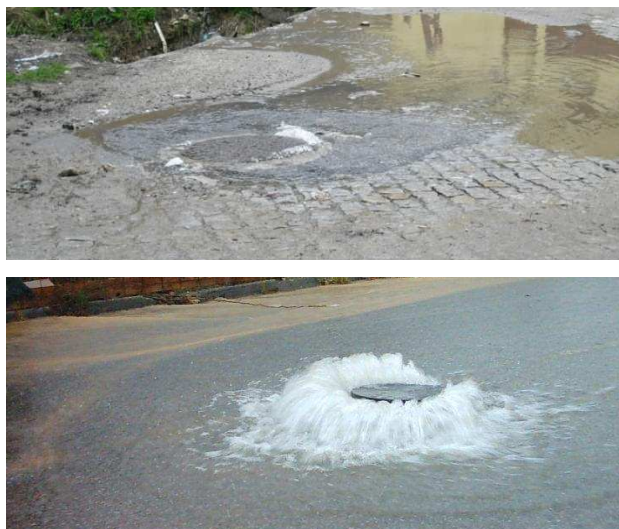
Figura 47 – Exemplos de exfiltrações (fonte: Águas de Gondomar, S.A.)
