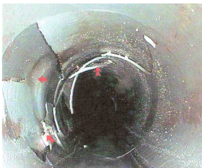
Figura 48 – Pormenor de imagem CCTV em colector (fonte: Águas de Gondomar, S. A.)
