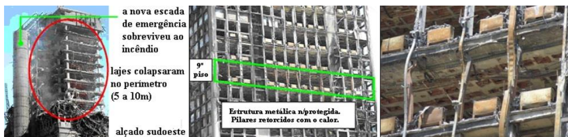
Figura 9 Efeitos do incêndio nas estruturas (Adaptado: Almeida, 2008)
