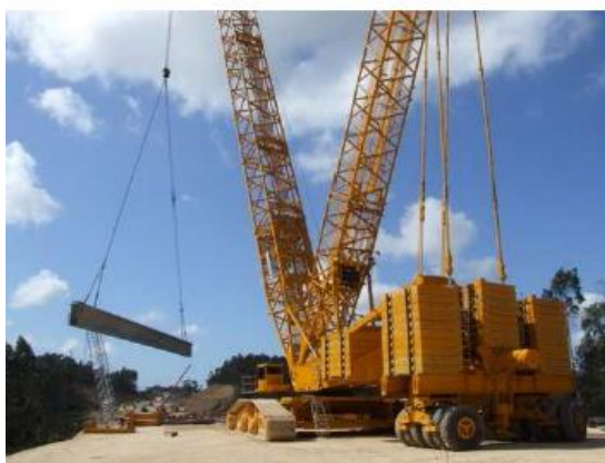
Figura 11 - Equipamentos de elevação [8]
