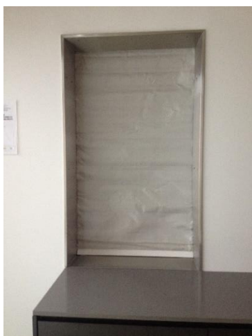
c) Cortina pára-chamas entre refeitório e cozinha
