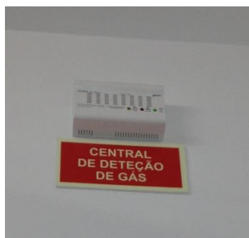
Figura 5.60 – Central de deteção de gás instalada na cozinha
