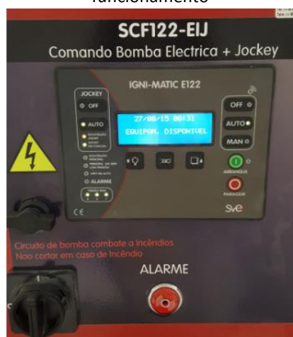
c) Mensagem na central de bombagem
