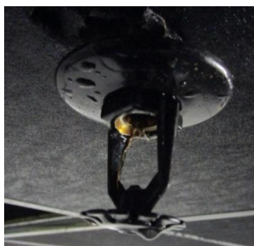
Figura 5.23 – Sprinkler com ampola rebentada na sala de projeção
