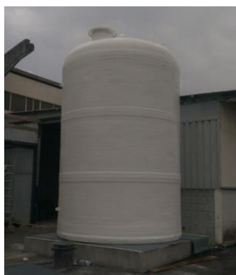
Figura 5.42 – Depósito privativo de incêndio
