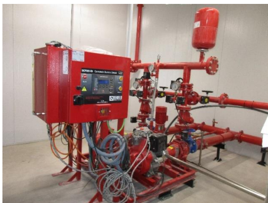
Figura 4.17 – Grupo de bombagem
