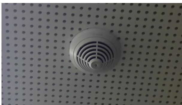
a) Detetor de fumo do teto falso
