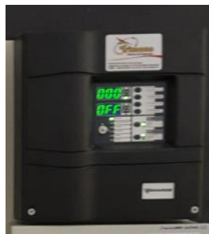
b) Central de deteção de CO
