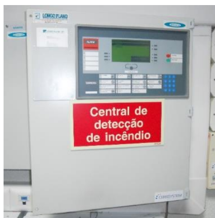
Figura 5.14 – Central de detecção de incêndio
