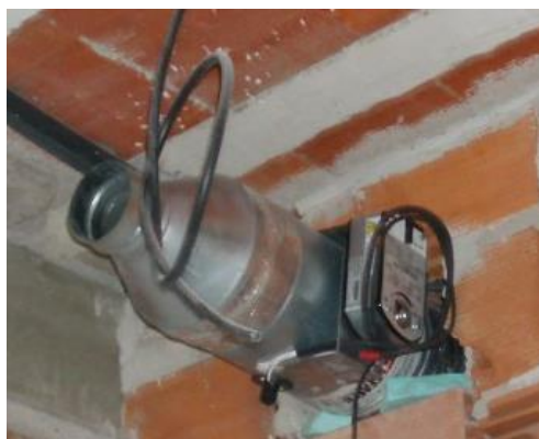
a) Registo corta-fogo na conduta
