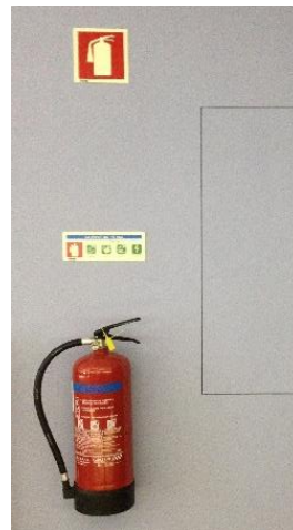
b) Extintor na entrada para a sala imax
