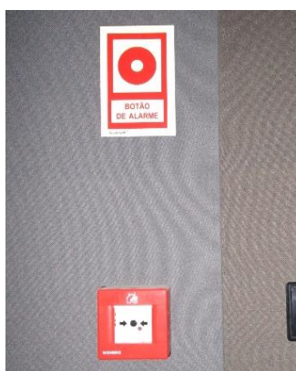
Figura 5.12 – Botão manual de alarme
