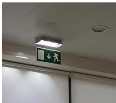
Figura 5.36 – Bloco autónomo com sinalização do caminho de evacuação
