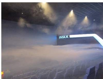
Figura 5.20 – Estado da sala de cinema aquando dos ensaios dos detetores de conduta
