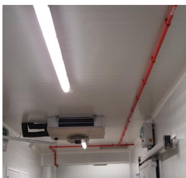
b) Detetor de aspiração (tubagem vermelha)
