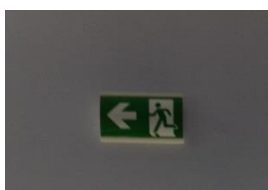
Figura 5.11 – Iluminação de circulação de uma das vias horizontais de evacuação
