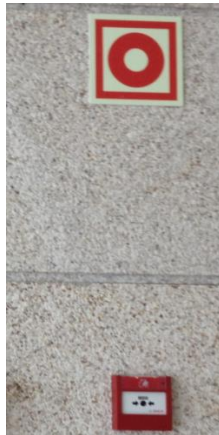
Figura 5.62 – Botão manual de alarme na entrada no edifício A e respetiva sinalética
