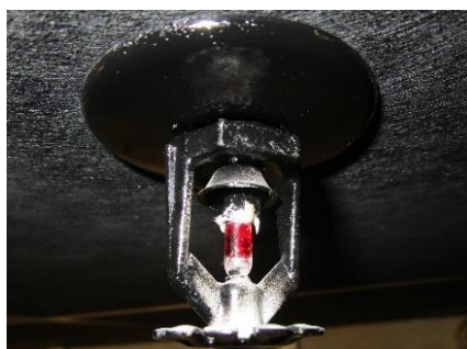
Figura 5.17 – Sprinkler da sala de projeção
