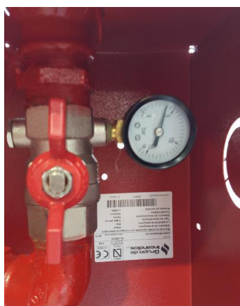
a) Pressão na rede aquando dos carretéis em funcionamento
