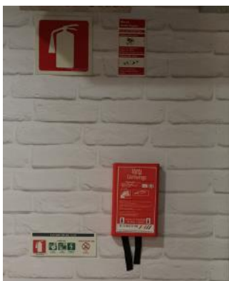
Figura 5.43 – Manta ignífuga na zona dos fornos
