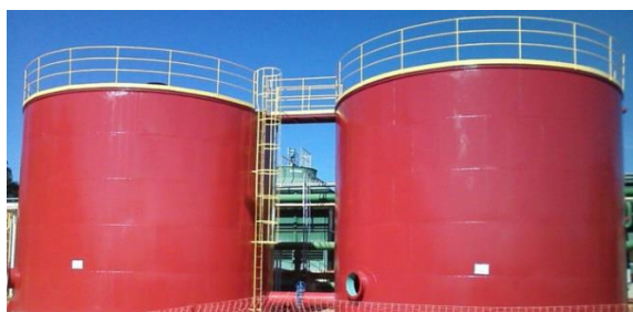
Figura 4.15 – Exemplo de reservatório de água
