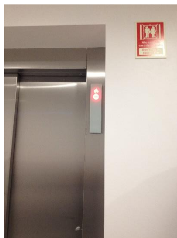
d) Elevador de serviço com indicação de alarme de incêndio
