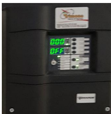
Figura 5.50 – Central de detecção de CO
