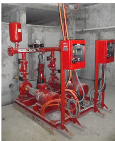
Figura 5.67 – Central de Bombagem do Piso -1
