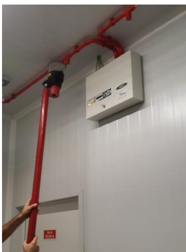
Figura 5.46 – Ensaios de detetor de aspiração
