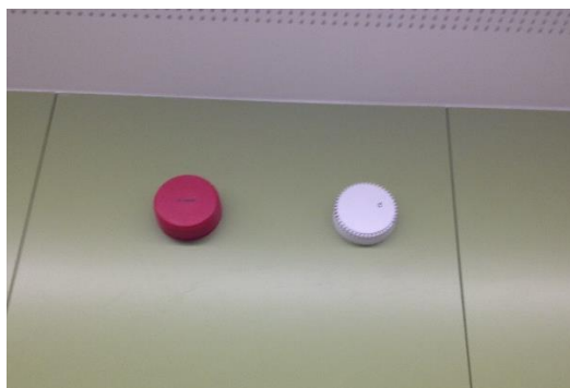
Figura 5.63 – Sirene de alarme instalado num dos corredores
