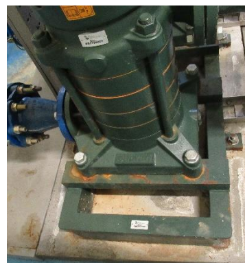
d) Indícios de corrosão (ETA de Pousada-Gôve)
