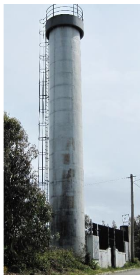
Figura 2.15 – Chaminé de Equilíbrio da EE de Seixo Alvo, em Vila Nova de Gaia (Fonte: AdDP)
