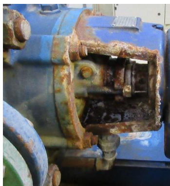
c) Corrosão generalizada (ETA de Castelo de Paiva)
