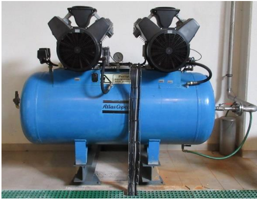
a) Motores e compressor
