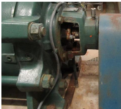
a) Corrosão no eixo (ETA do Ferro)
