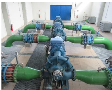
a) Grupos eletrobomba
