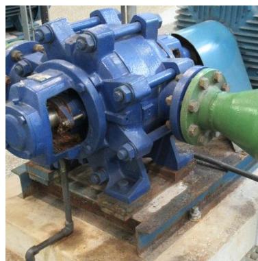
b) Corrosão nos apoios (ETA de Ferreira)
