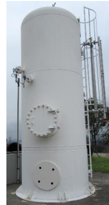
b) Reservatório de Ar Comprimido
