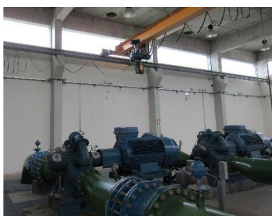
a) Conduitas, válvulas e acessórios
