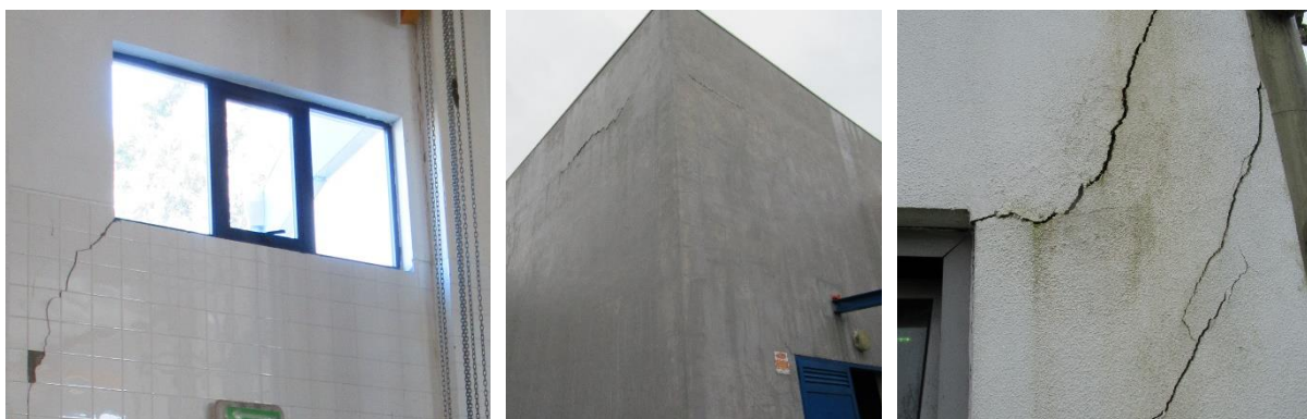
a) Fissura interior, junto a elemento fenestrado
