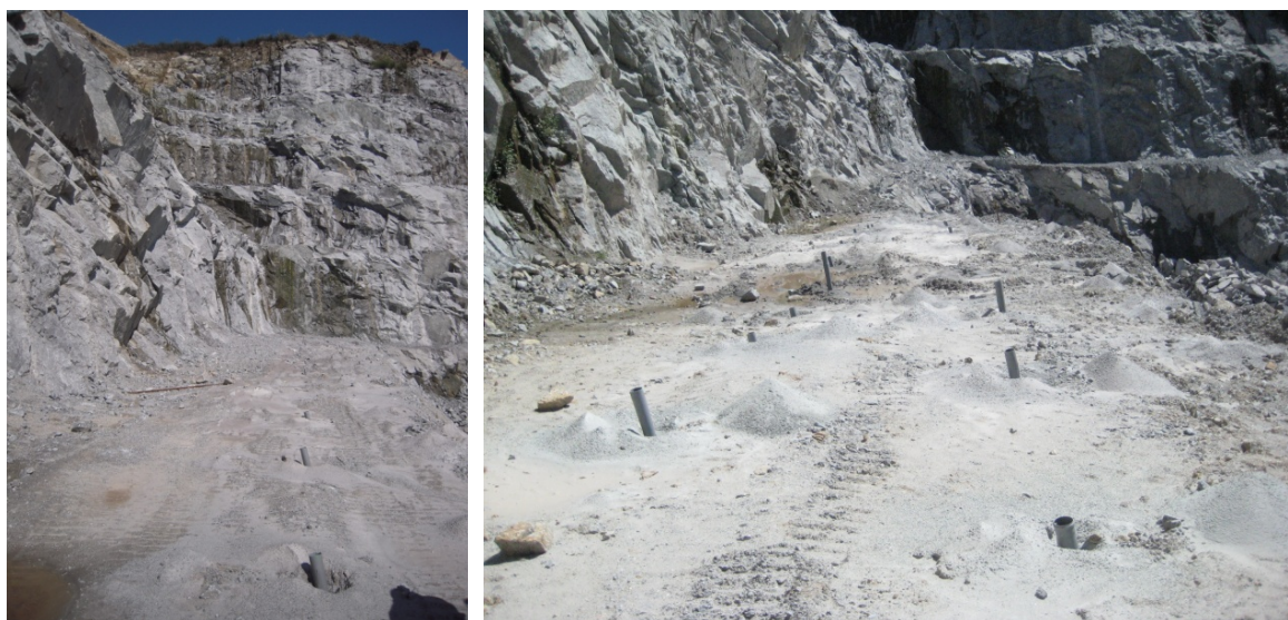
Figura 84. Aspecto da bancada n.º 0 antes e após a realização do desmonte (pega 1) – Pedreira de Serdedelo.
