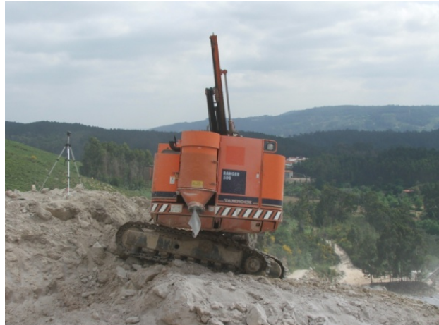
Figura 22. Exemplo de instabilidade do equipamento.
