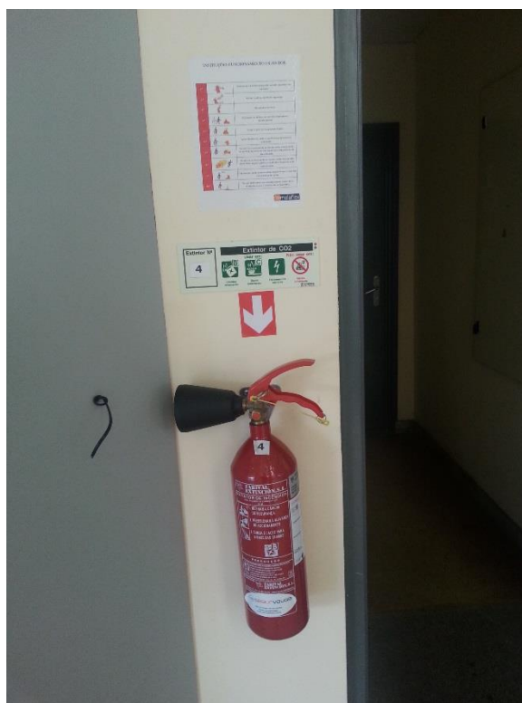
Ilustração 27- Extintor nº4 com sinal agente e instruções de utilização
