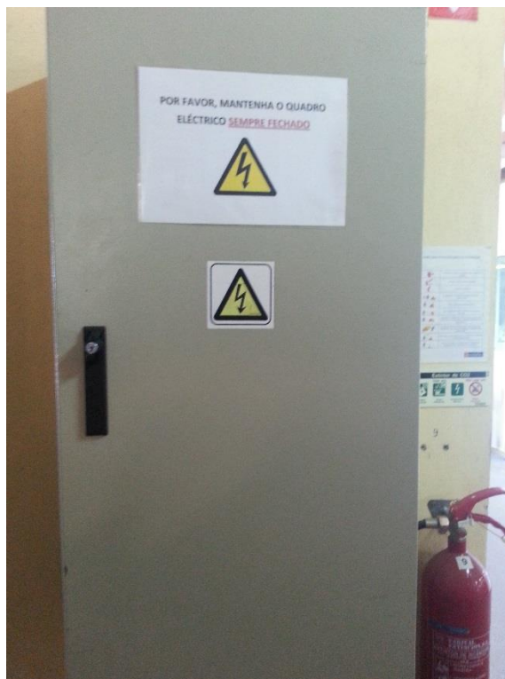
Ilustração 24- Sinalização de Segurança de um Quadro Elétrico
