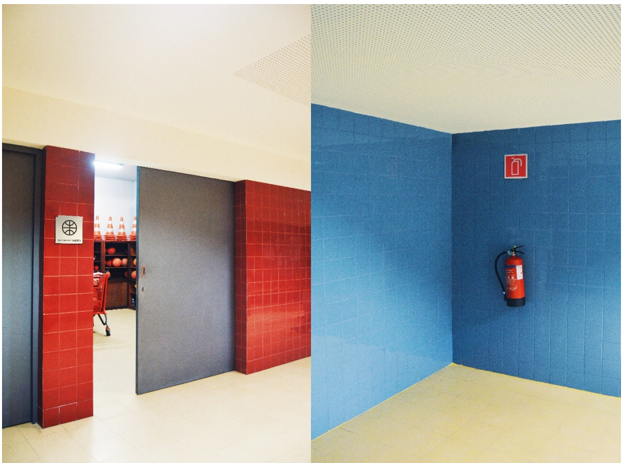
Figura 71. Identificação da sala de equipamentos e do extintor de incêndio.
