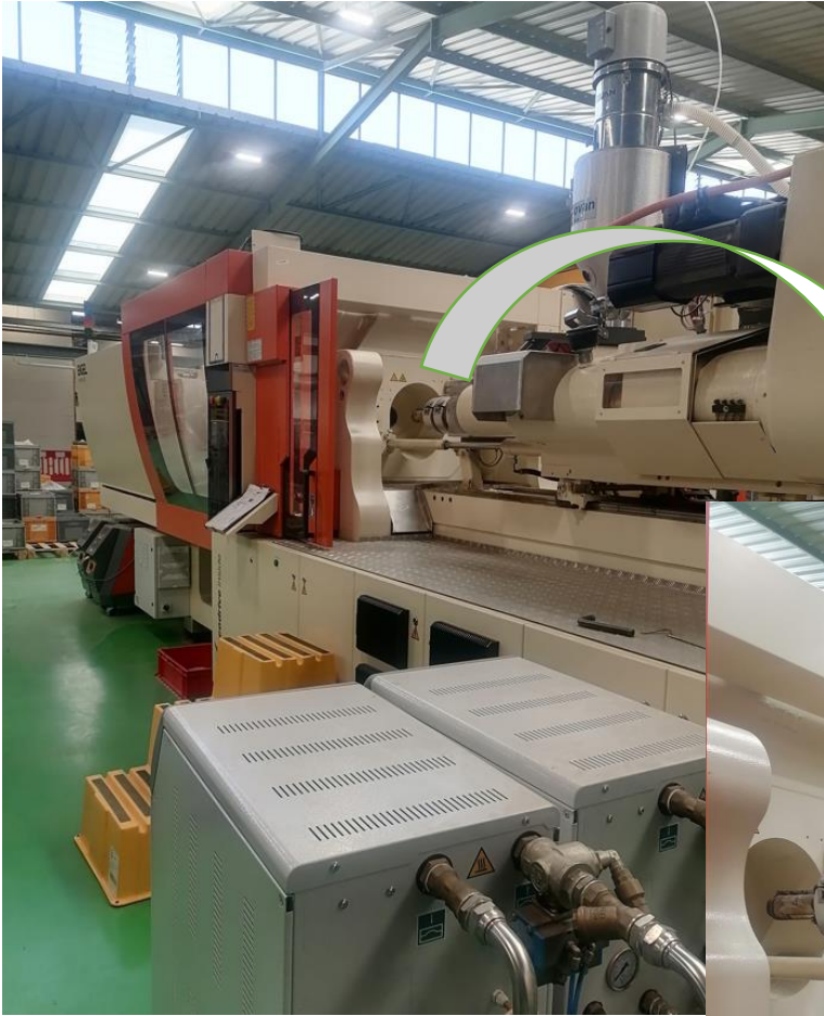
Figura 29- Máquina de injeção
