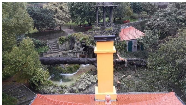
Figura 2 - Vista do escritório da CSR, estragos causados pela queda da árvore
