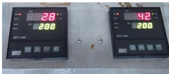
Figura 47 - Controladores de temperatura utilizados.
