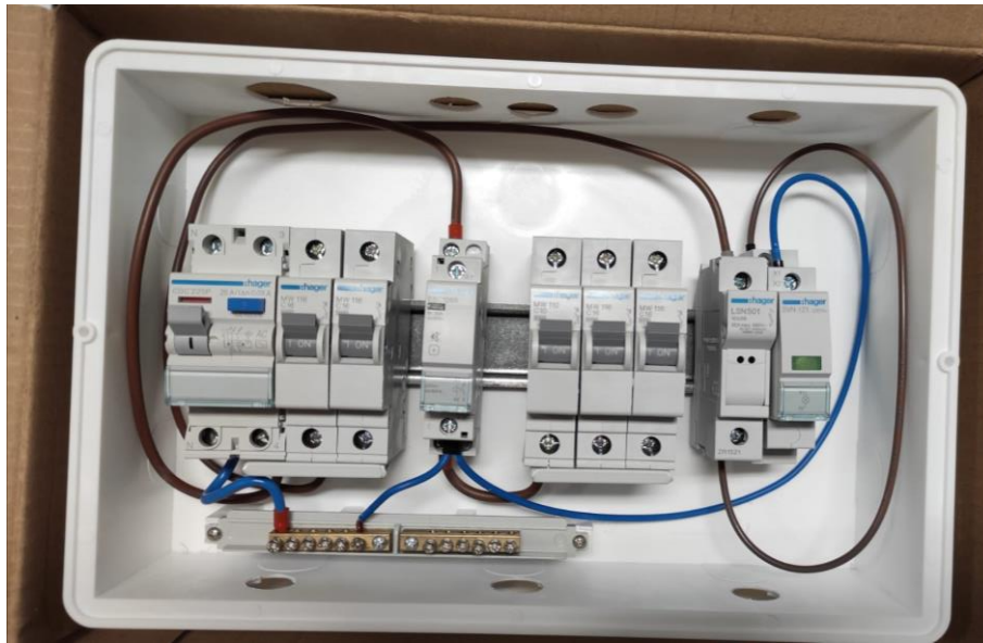
Figura 24 – Quadro elétrico após inspeção visual.
