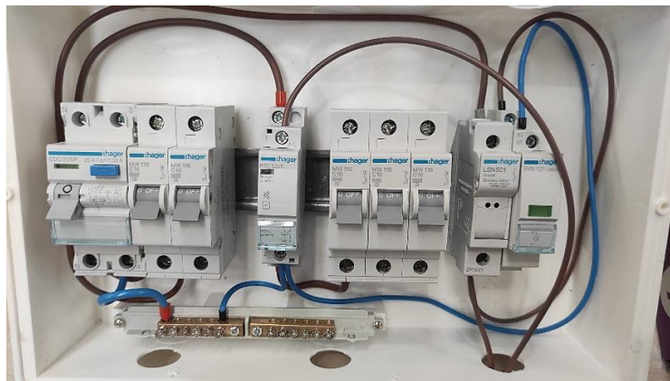
Figura 15 – Quadro elétrico montado.
