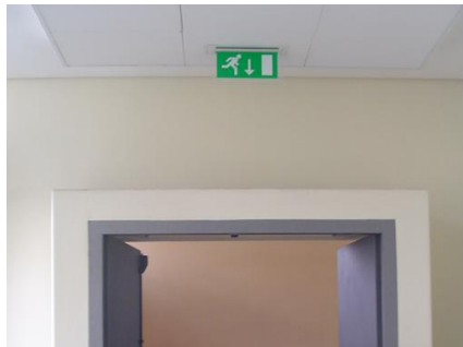
Figura 21 - Iluminação de emergência – Edifício I.
