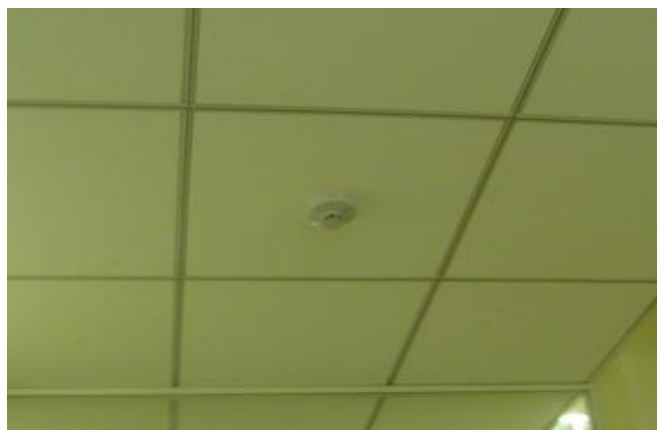
Figura 24 – Detector de fumo-Edifício J
