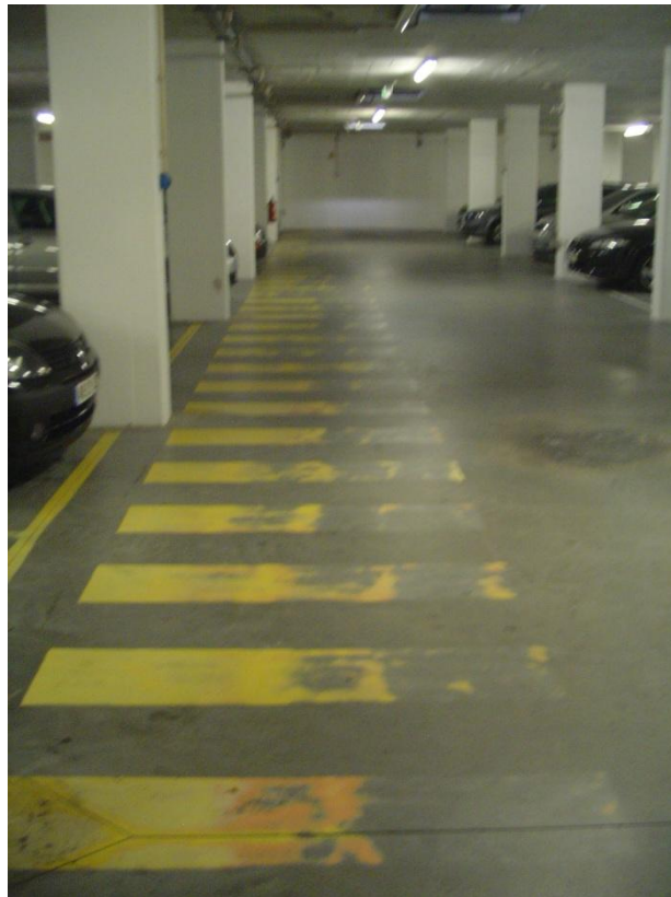
Figura 9 – Sinalização de caminho de evacuação.
