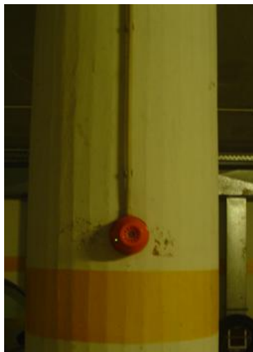
Figura 26 – Detector de gás combustível-Edifício E
