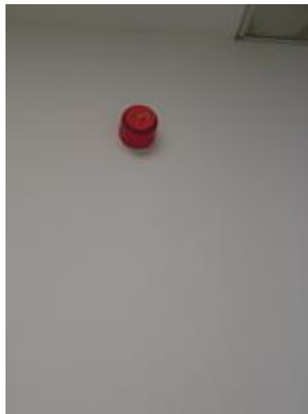
Figura 23 - Difusor de alarme-Edifício F
