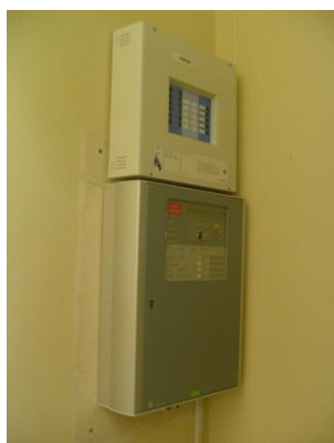
Figura 25 – Central de alarme de incêndio-Edifício J
