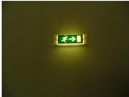
Figura 20 - Iluminação de emergência – Edifício A.
