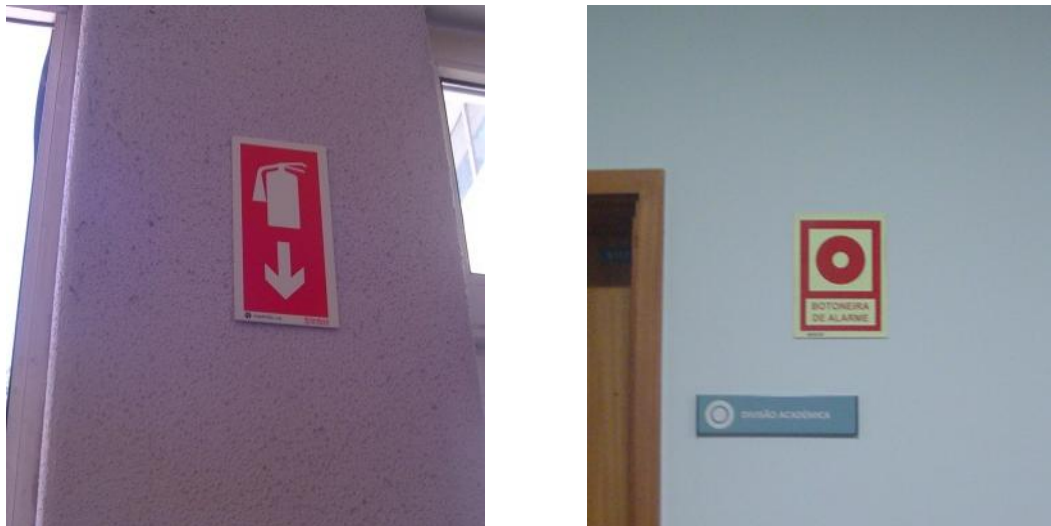
Figura 7 – Placas fotoluminescentes de extintor e botoneira de alarme.
