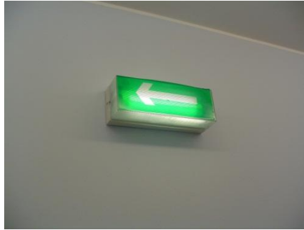
Figura 10 – Iluminação de emergência – Edifício E.
