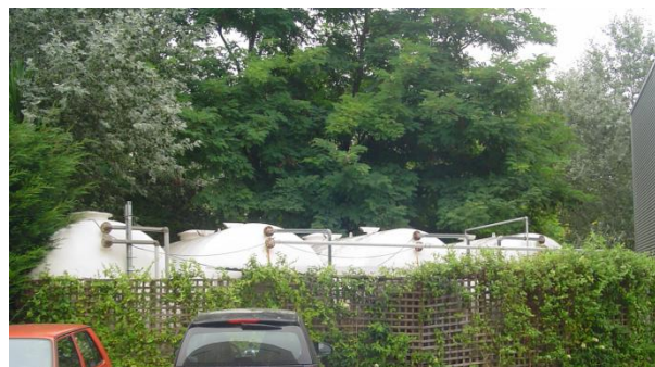
Figura 2 – Depósitos de serviço de incêndio
