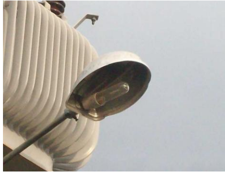
Figura 75 - Luminária inadequada para utilização em IP.
