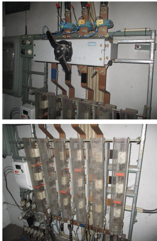
Figura 111 - Barramento do QGBT
