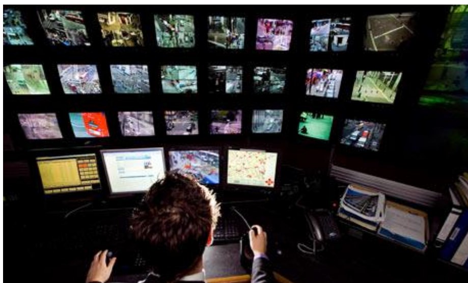
Figura 17 – Sistema CCTV (central de controlo) 22
