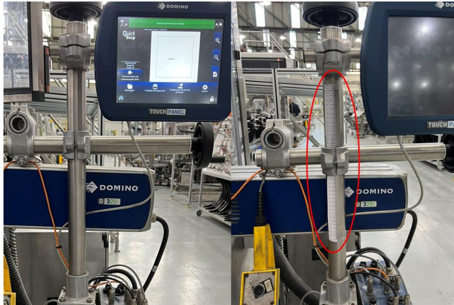
Figura 40 - Laser de marcação do nº de lote antes (a) e após (b) colocar a régua provisória
