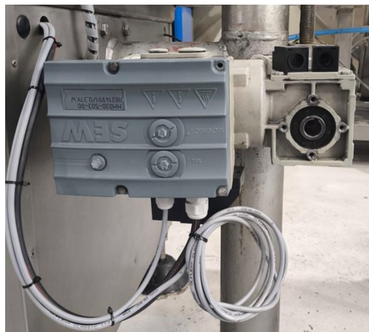
Figura 50 - Motor instalado no depósito do Rolhador Bartop
