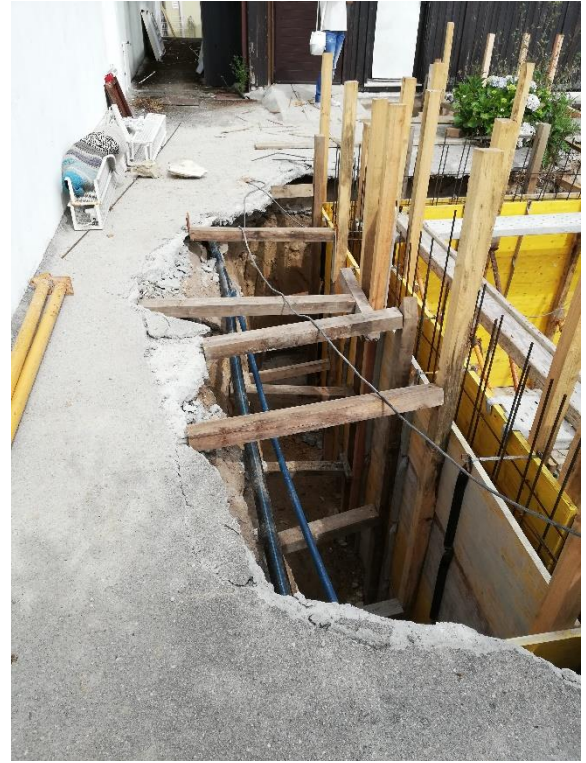
h) Falta de guardas-corpos
