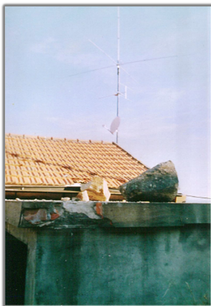
Figura 1. Fotografia do bloco que atingiu a habitação no Verão de 2004 (foto gentilmente cedida pela Câmara Municipal de Amarante; Pormenores em NEC & LABCARGA (2015).
