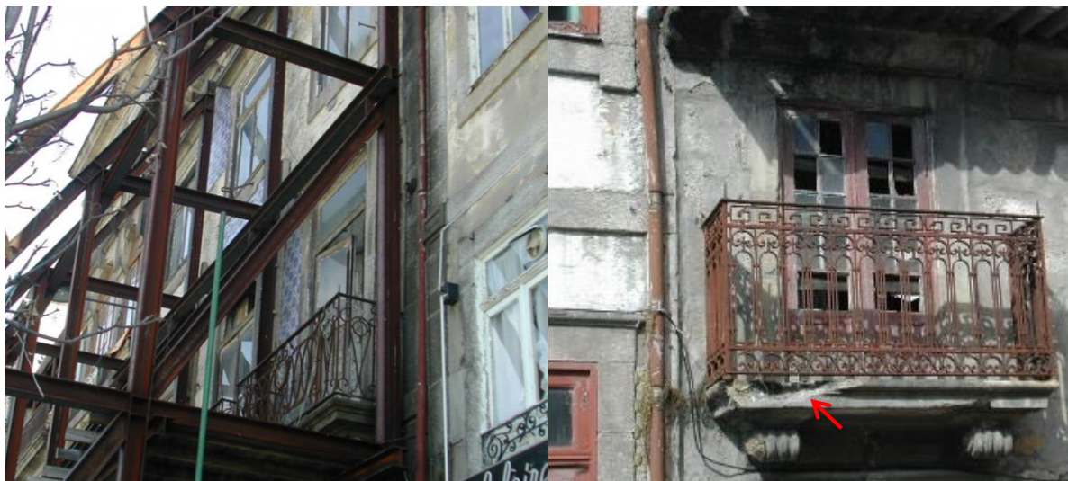
a) Risco de colapso dos elementos de alvenaria b) Rotura na lajeta em pedra da varanda.
