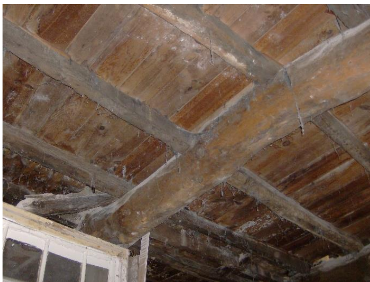
Figura 18 - Pavimento de madeira com degradação por ação da humidade, por ataques de fungos e insetos xilófagos.
