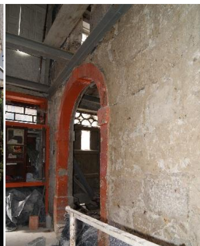
Figura 24 – Pormenor de arco na parede.
