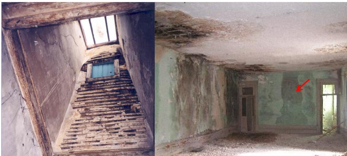
a) Degradação num estado avançado nas paredes de tabique do saguão. b) Presença de humidade nas paredes de tabique.
