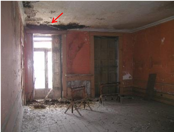
a) Degradação dos elementos em madeira de suporte de teto.
