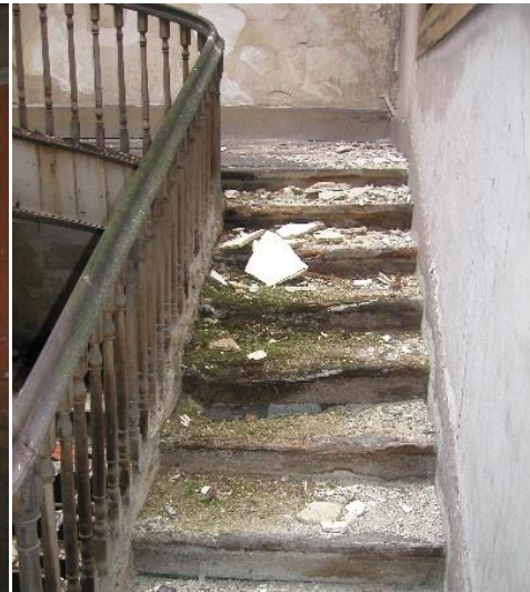
b) Degradação dos elementos de madeira das escadas.
