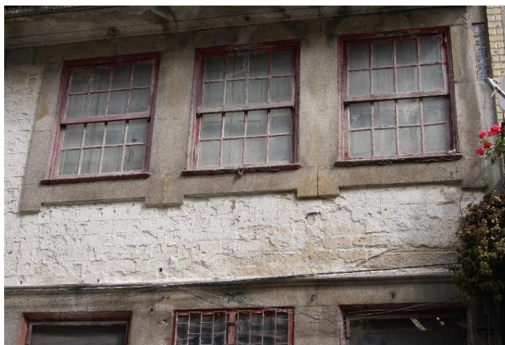
Figura 23 – Pormenor da degradação da fachada.
