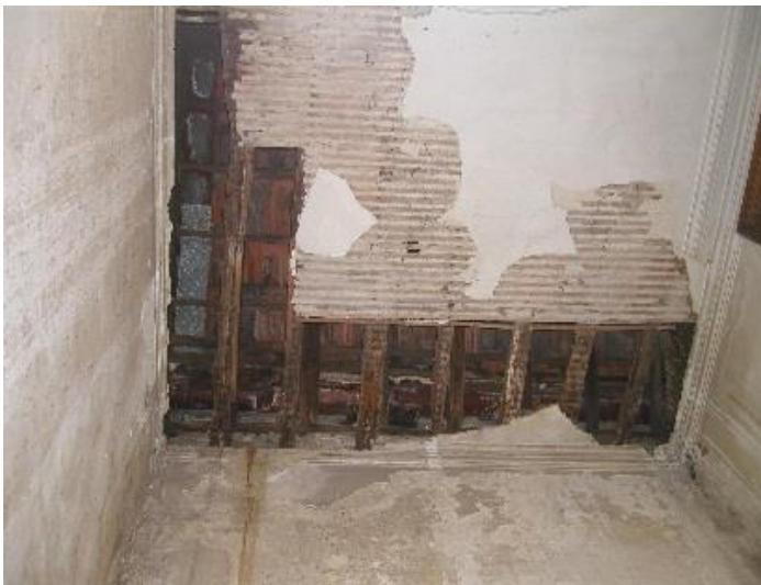
c) Degradação dos elementos em madeira de suporte de teto e cobertura.
