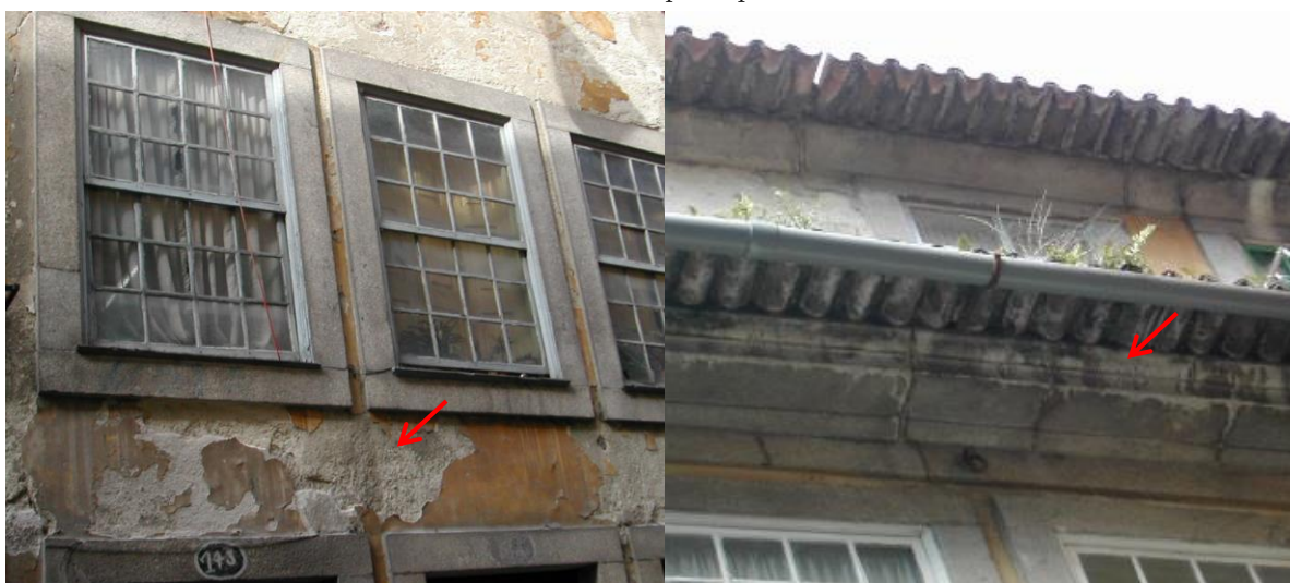
e) Destacamento do reboco na fachada principal.
