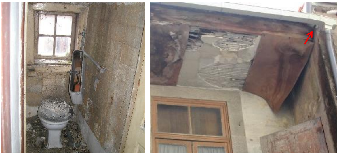
a) Degradação dos equipamentos sanitárias b) Corrosão dos elementos de fixação da tubagem de drenagem das águas pluviais.
