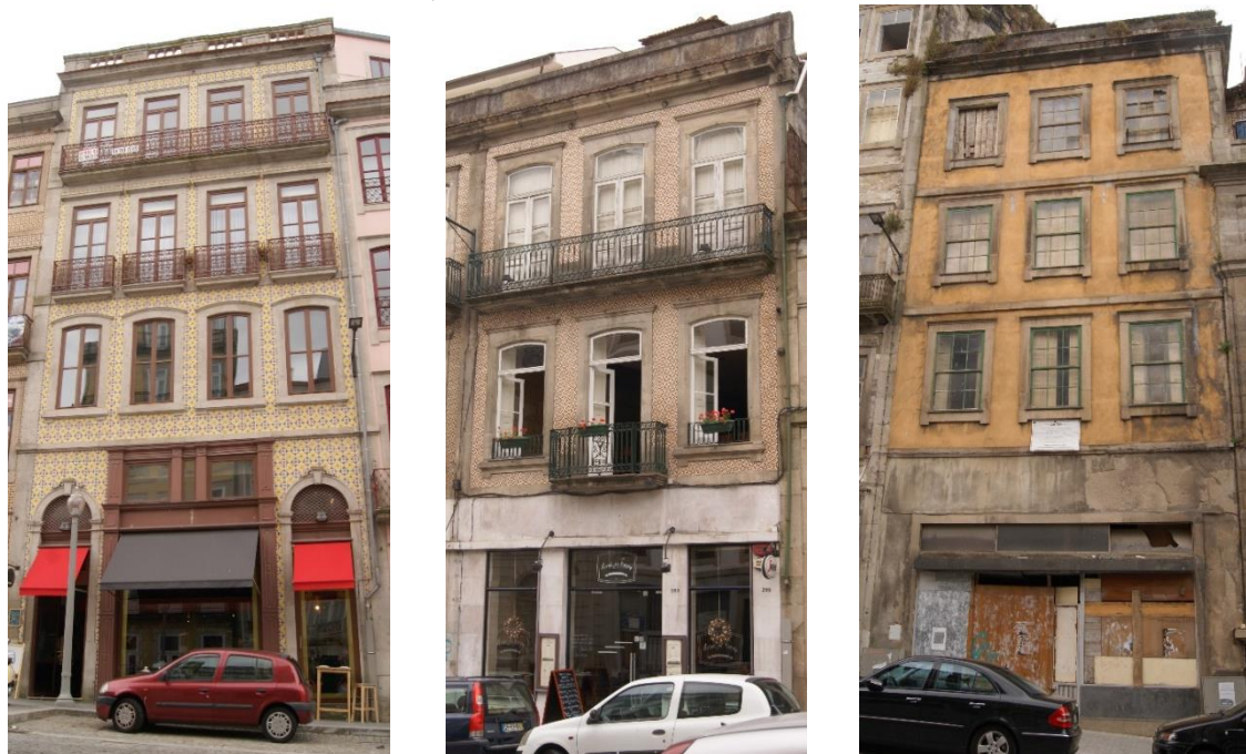
a) Fachada em muito bom estado. b) Fachada em médio estado. c) Fachada em mau estado.
