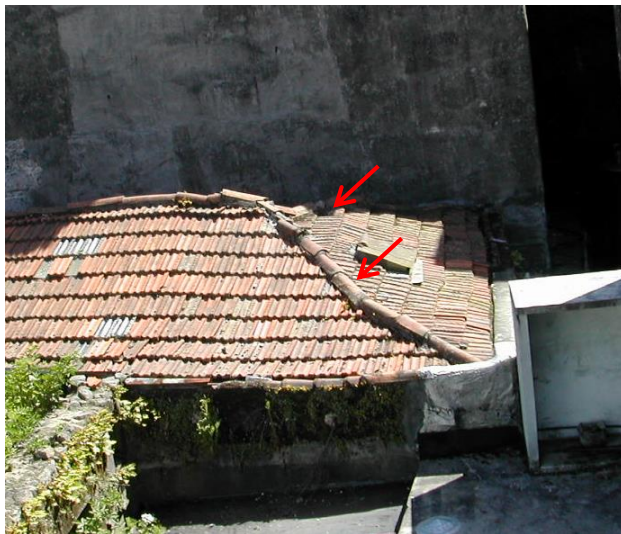
a) Deformação perceptível na cobertura.
