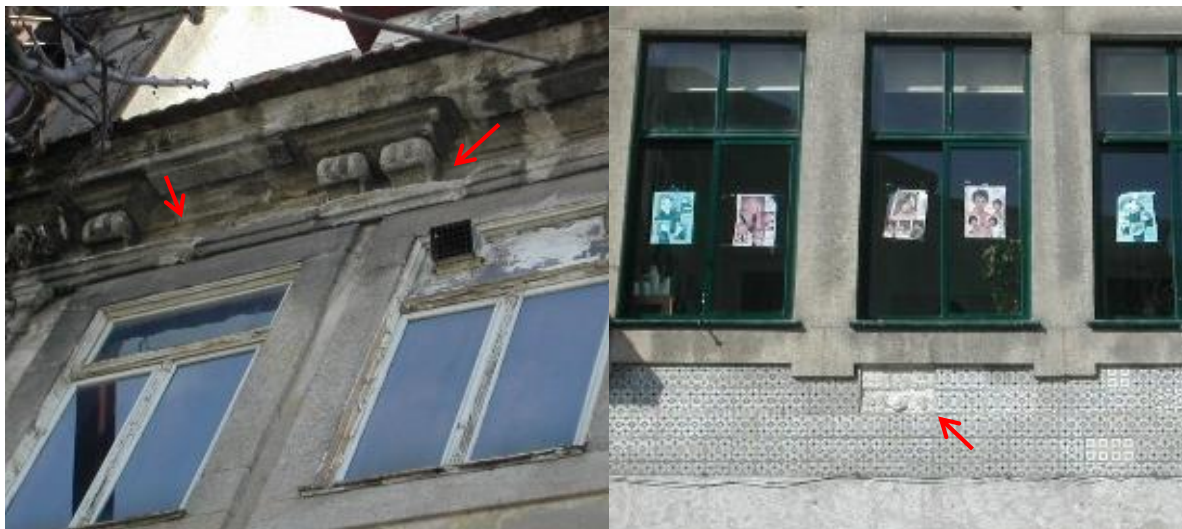
c) Degradação dos ornamentos em pedra.
