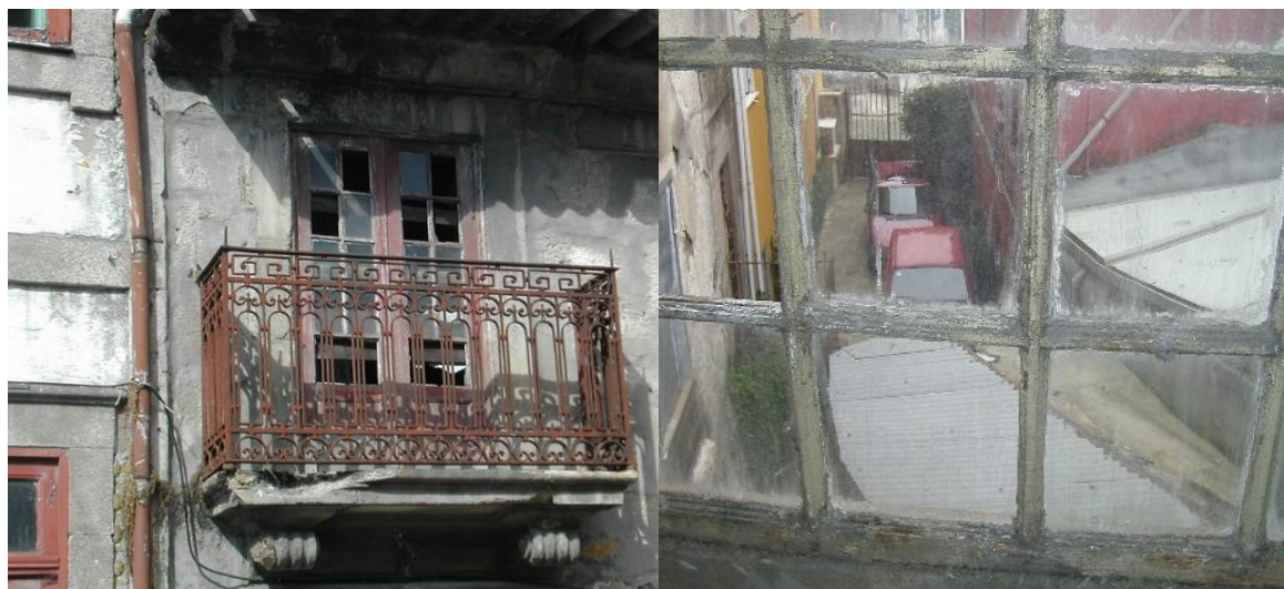
c) Corrosão dos elementos metálicos do gradeamento. d) Envelhecimento das caixilharias de madeira.
