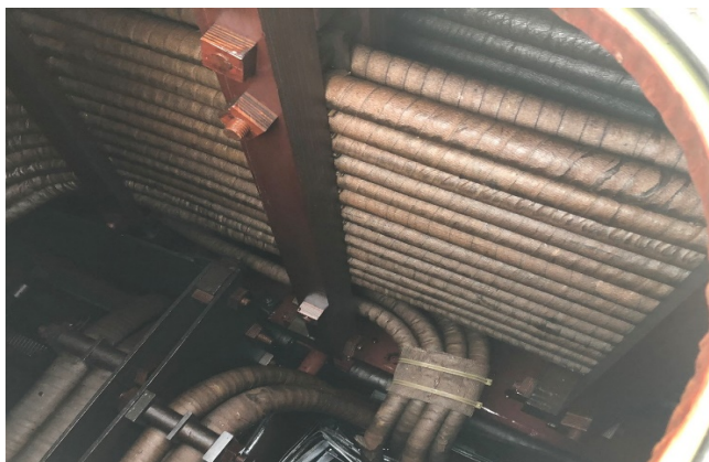
Figura 13- Fixação e isolamento sólido de ligações das tomadas de regulação aos enrolamentos de um transformador de potência (Fonte :REN)
