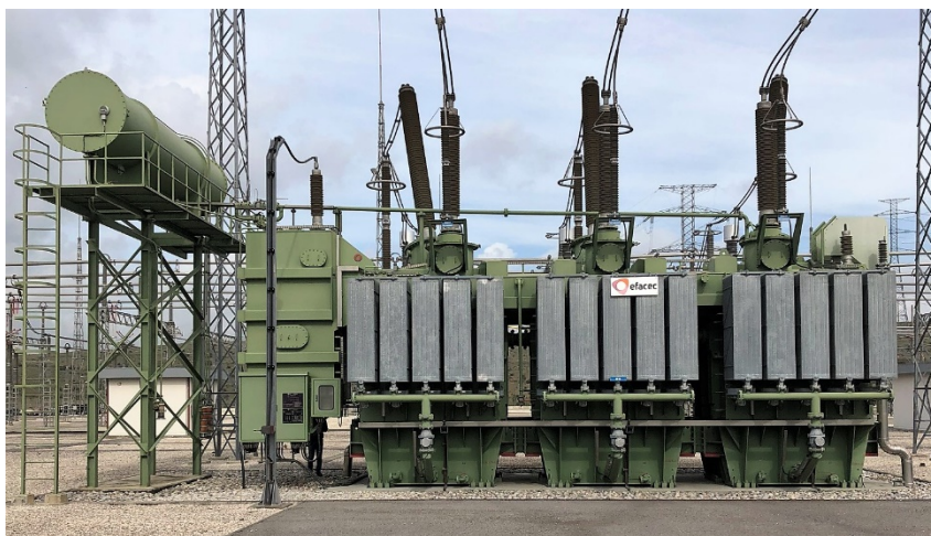
Figura 4 - Autotransformador trifásico de fases dissociadas da RNT, 450 MVA ( Fonte: REN)
