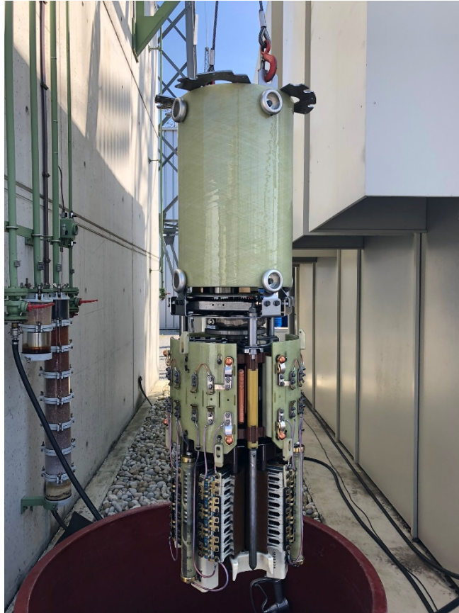
Figura 15 - Comutador de um autotransformador da RNT em processo de manutenção (Fonte: REN)
