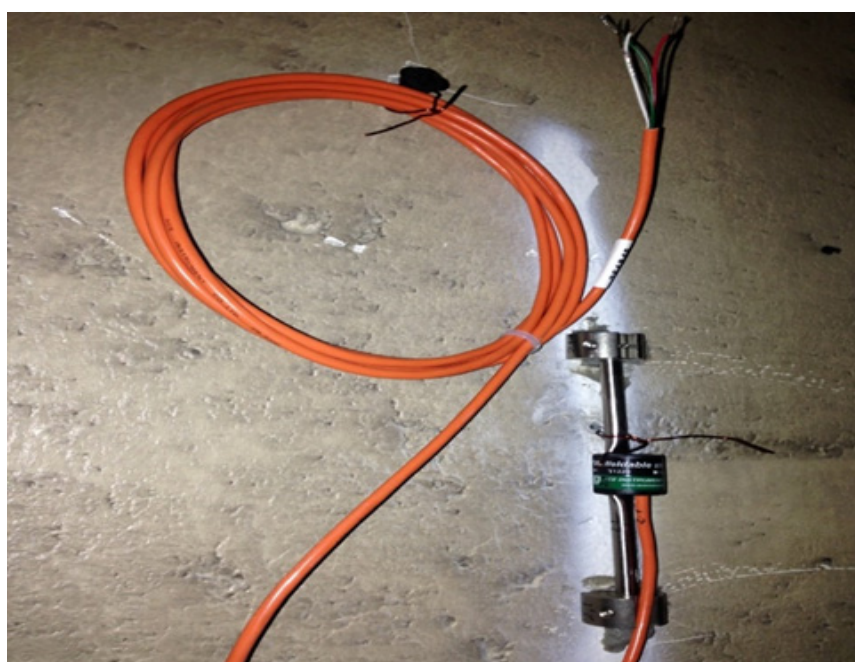
Figura 25. Fissurômetro de corda vibrante. (arquivo fotos RRC; com autorização).
