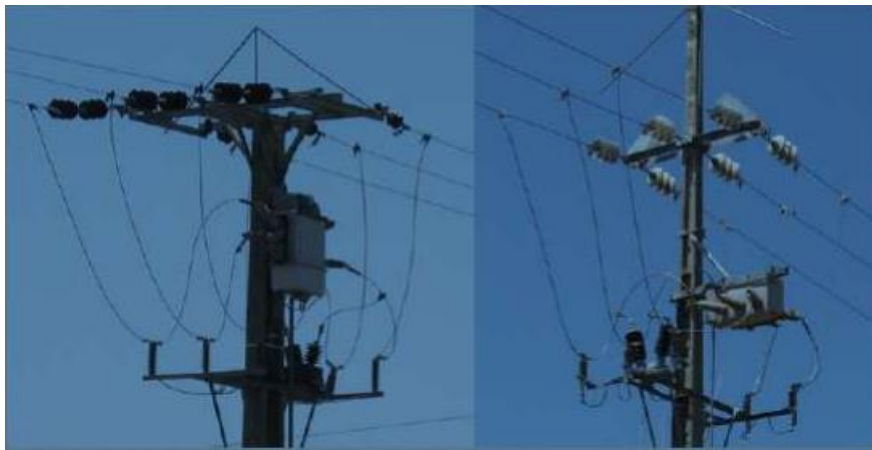
Figura 2.12 - Órgão de corte de rede de média tensão do tipo 1.
