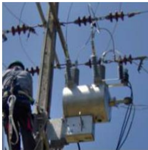
Figura 2.13 - Órgão de corte de rede de média tensão do tipo 2.
