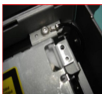
Falta de parafuso
