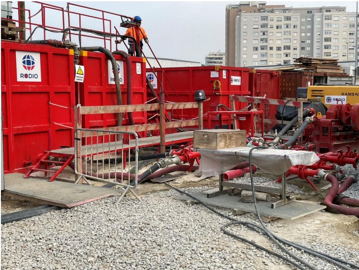
Figura 29 – Estação de tratamento de polímero.
