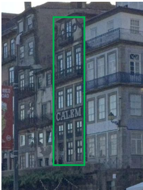
Figura 2.28 – Estado inicial da fachada do restaurante Calém
