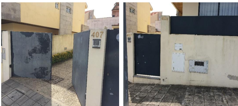
Figura 2.24 – Estado inicial do muro
