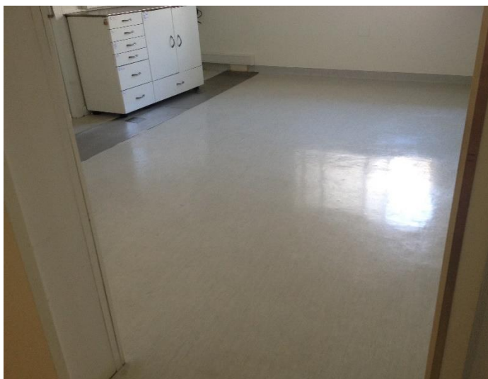
Figura 2.30 – Estado inicial do pavimento
