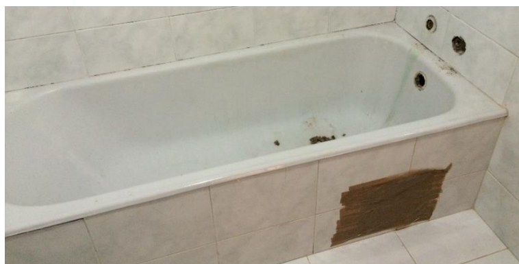
Figura 2.19 – Estado inicial da banheira na casa de banho
