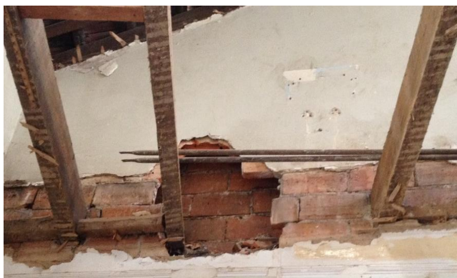
Figura 4.9 – Estado inicial das paredes em contacto com edifícios adjacentes
