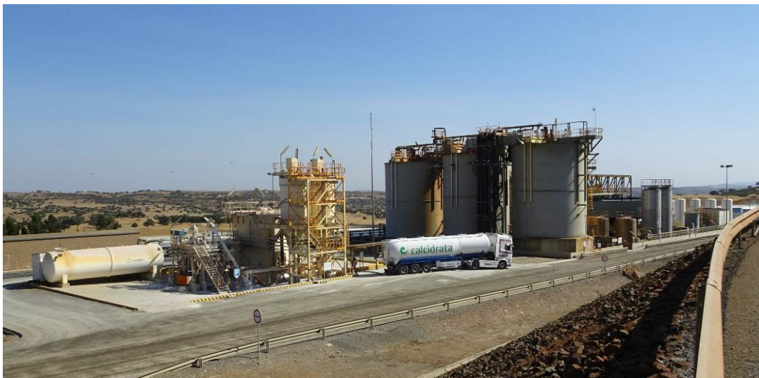
Figura 59 – Vista geral da ETAI.
