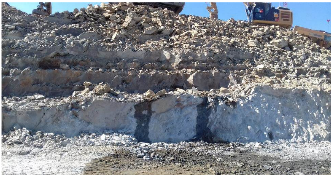
Figura 70 – Caminhos preferenciais de circulação de água observados numa escavação na IRCL.
