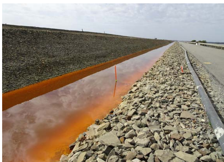
Figura 46 – Vala de água contaminada no interior da IRCL (água de contacto).
