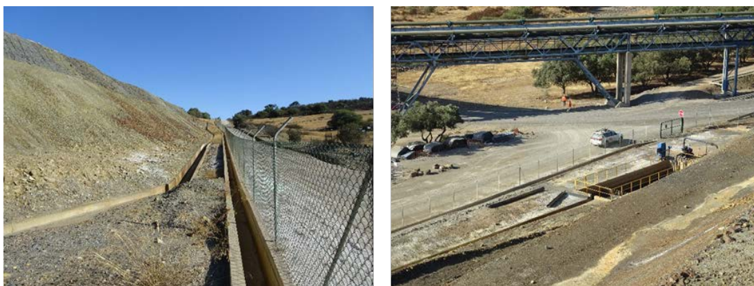
Figura 57 – Dupla vala perimetral que envolve toda a escombreira, e tanque de recolha das águas de escorrência superficial da escombreira que são coletadas nas valas perimetrais.
