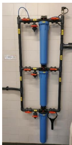
Figura 14 – Sistema de microfiltros pré-osmose da clínica de Marco de Canaveses.
