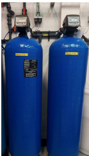
Figura 12 – Filtros de carvão ativado da clínica de Paredes.
