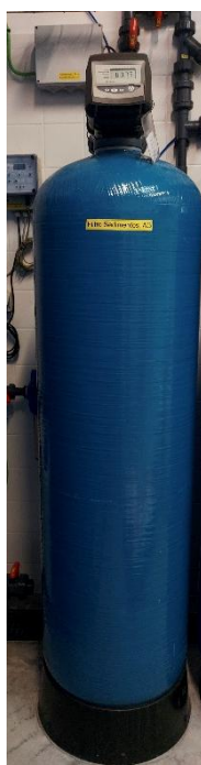
Figura 10 – Filtro multimédia da clínica de Paredes.
