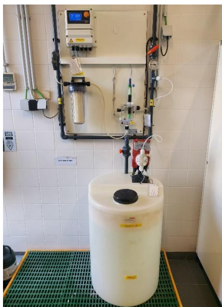
Figura 11 – Sistema de cloração da clínica de Marco de Canaveses.
