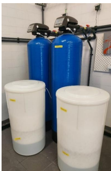
Figura 13 – Descalcificadores e tanques de salmoura da clínica de Marco de Canaveses.
