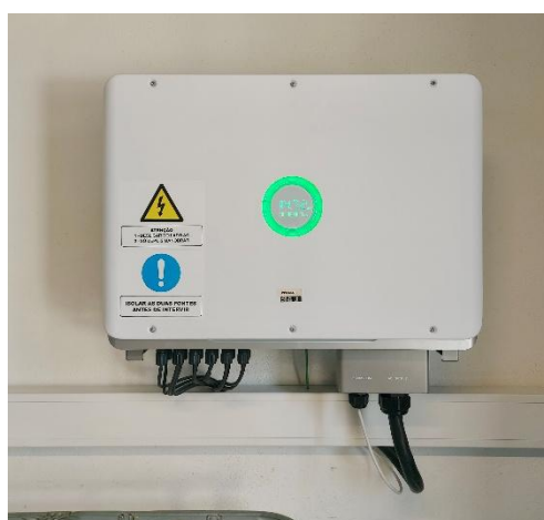
Figura 22 – Controlador dos painéis fotovoltaicos com mostrador da produção.
