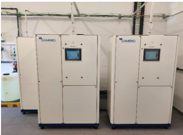
Figura 23 – Sistema de osmose inversas com desinfecção térmica da clínica de Marco de Canaveses.
