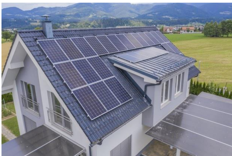
Figura 51 - Aplicação de painéis fotovoltaicos [43]
