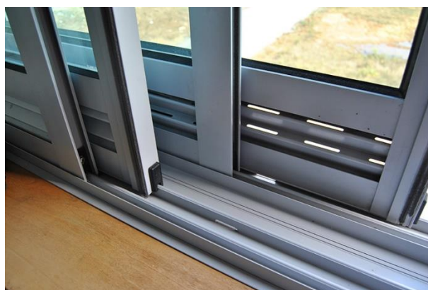
Figura 48 - Envidraçado com janelas duplas com caixilharia em alumínio[39]
