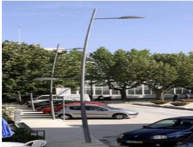
Figura 28 - solução de Led coluna octogonal e luminária Voltana 3 normalizada com potência 80w
