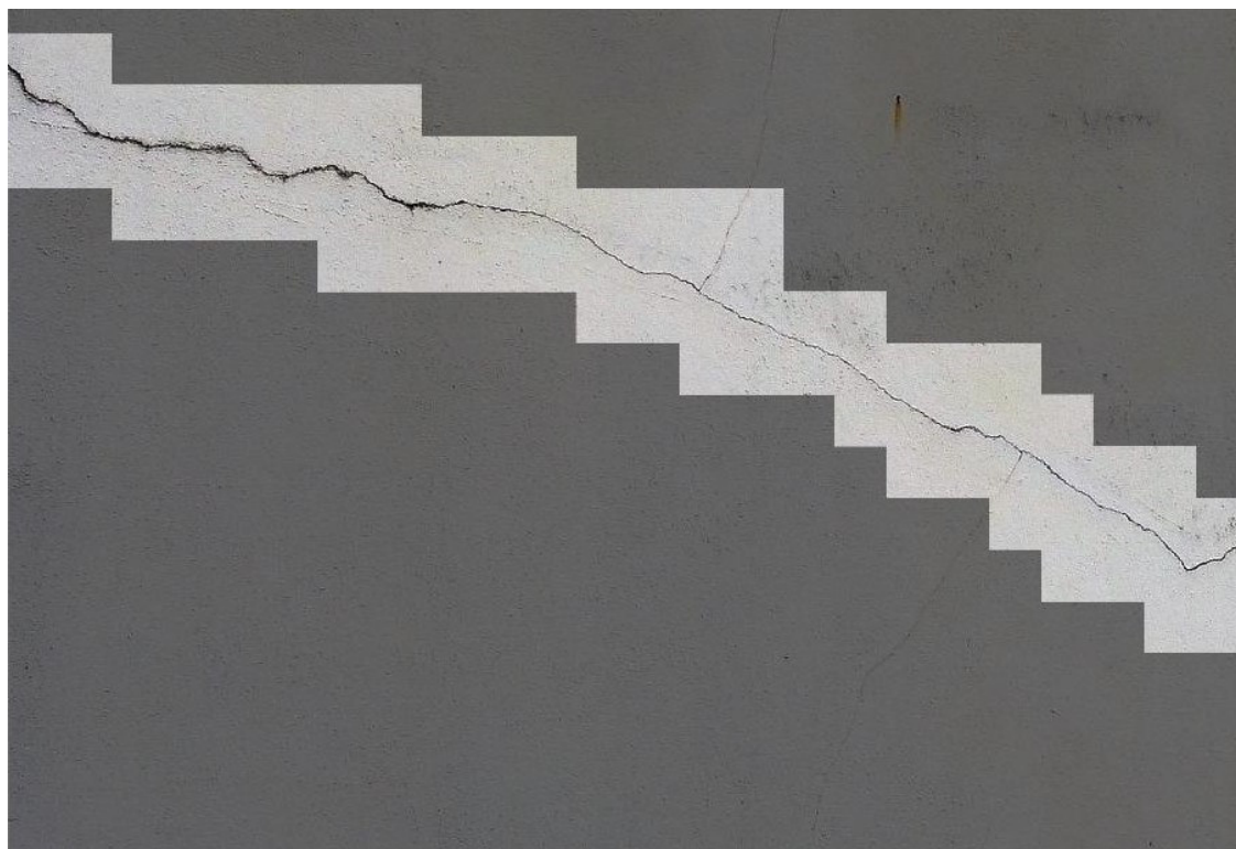
Figura 6-43 – Detecção Fissura Z.F.12
