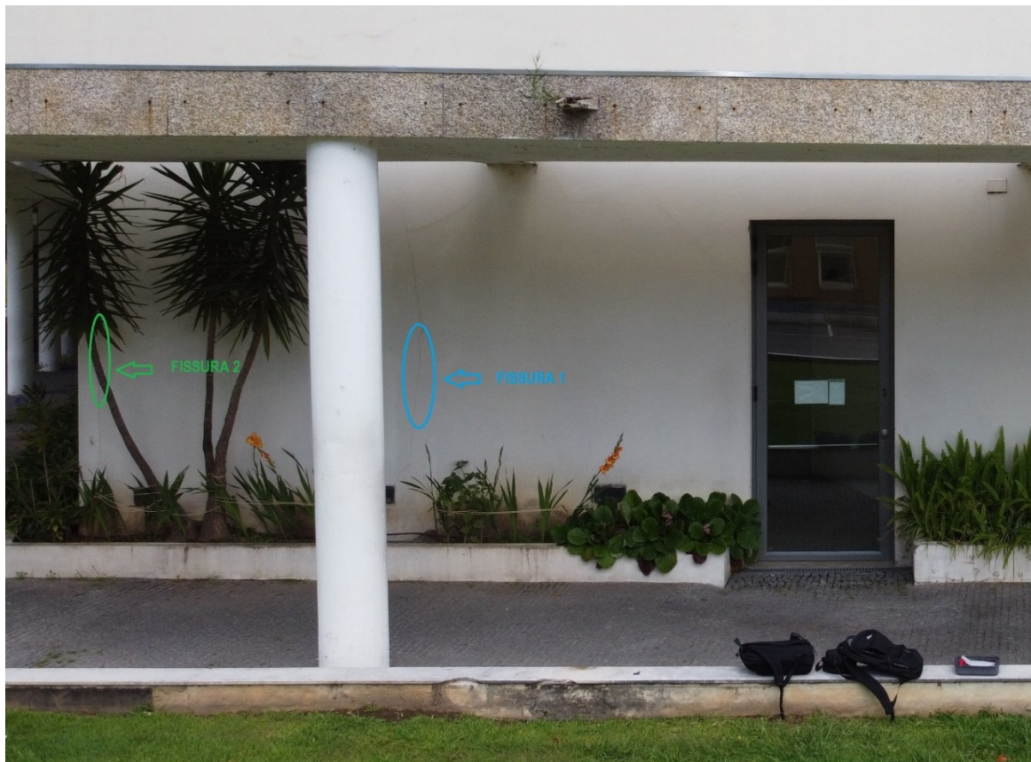
Figura 6-4 – Localização das fissuras 1 e 2
