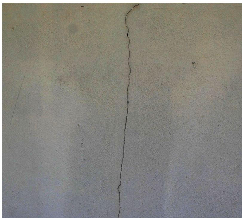
b) Fotografia Fissura 1
