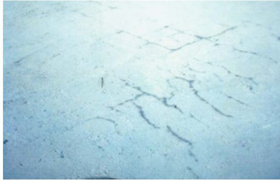
Figura 2-10 - Fissuras por deficiente cura do betão
