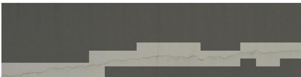
Figura 6-29 – Detecção Fissura Z.F.05
