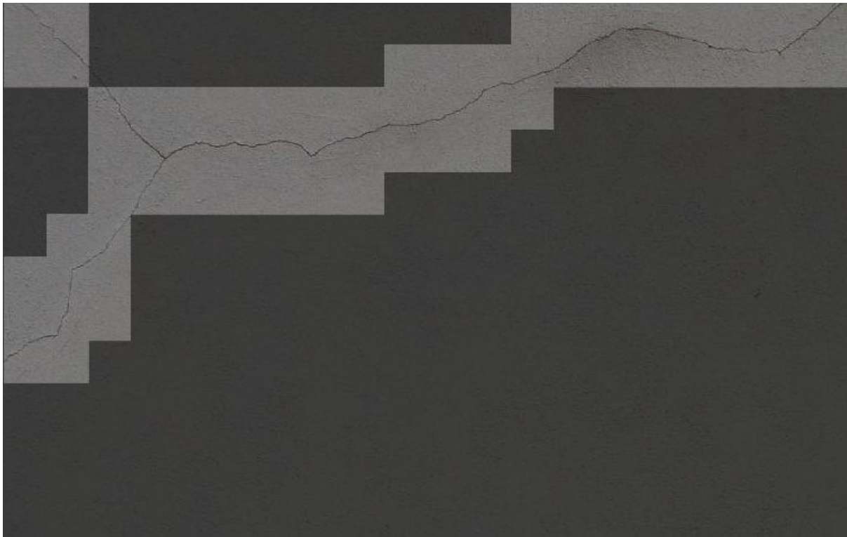
Figura 6-33 – Detecção Fissura Z.F.07
