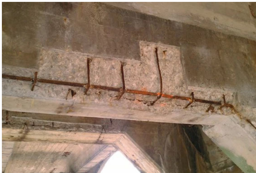
Figura 2-14 – Fissuras por corrosão da armadura
