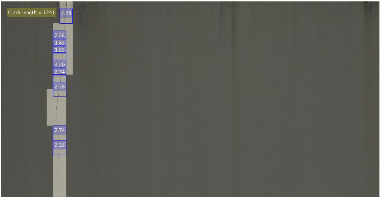
Figura 6-49 – Dados Caracterização Fissura Z.F.02
