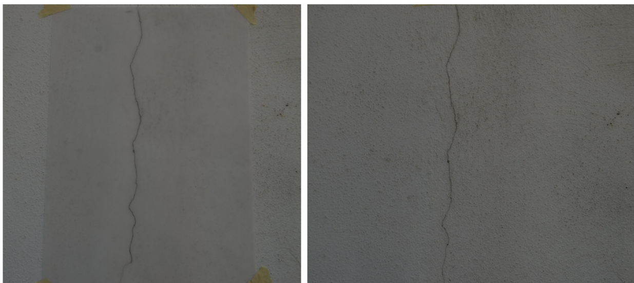
a) Fotografia da Marcação Fissura 3
