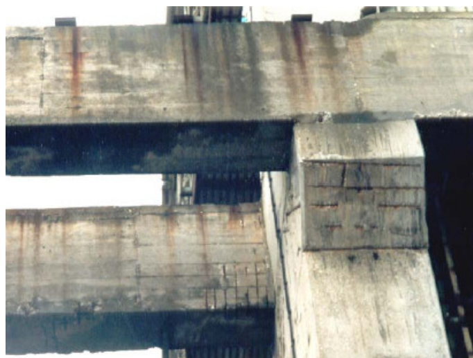
Figura 2-16 – Fissuras por mau posicionamento de armaduras
