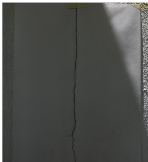
a) Fotografia da Marcação Fissura 2
