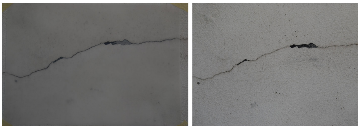
a) Fotografia da Marcação Fissura 4
