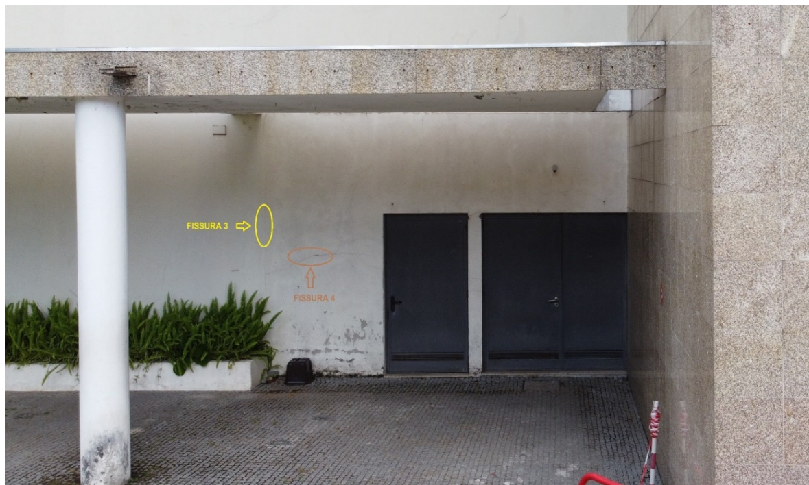
Figura 6-5 – Localização das fissuras 3 e 4
