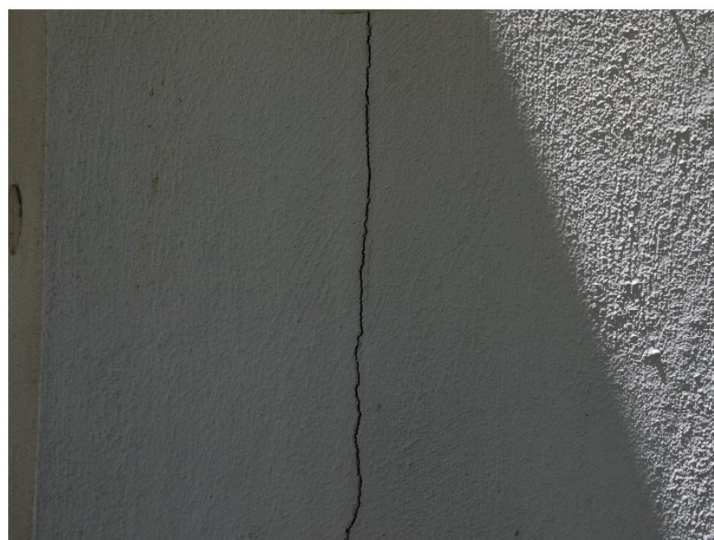
b) Fotografia Fissura 2
