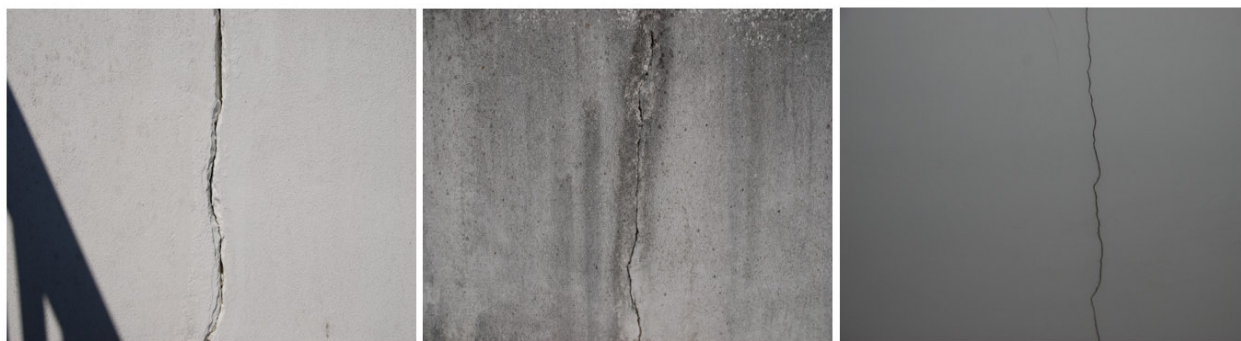
Figura 2-9 - Exemplo de três fissuras em muros de suporte (Eurico Carola, 2021)
