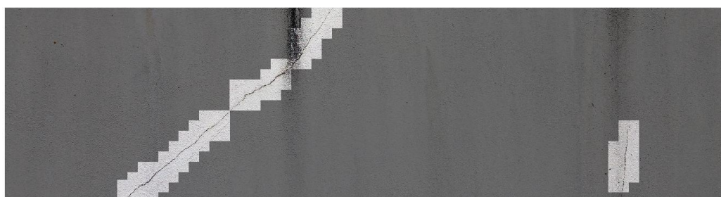
Figura 6-25 – Detecção Fissura Z.F.03
