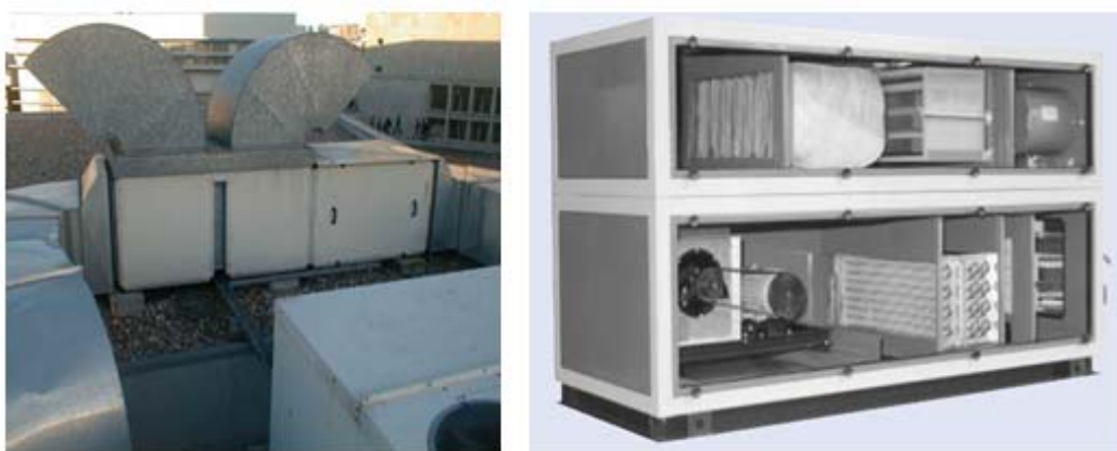
Figura 6-1 – Unidades de Tratamento de Ar (UTA's) vista externa e interna, respectivamente.
