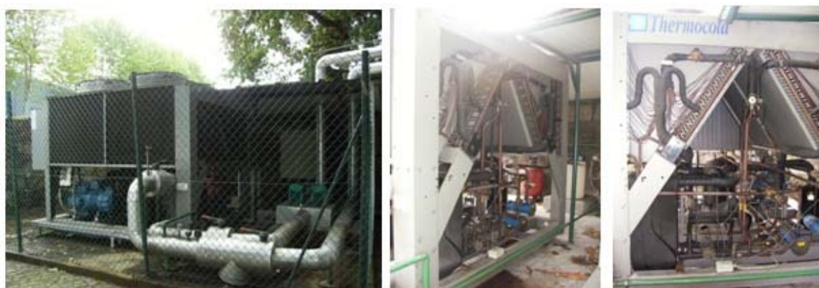
Figura 6-2 – Fotografias do Chiller Bomba de Calor da COCIGA S.A.
