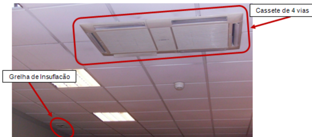
Figura 8-3 - Vista do tecto da Comercial – Produtos, assinaladas a grelha de insuflação e uma das cassetes de 4 vias.
