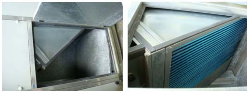
Figura 8-19 – Vista do permutador da UTA.
