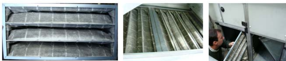
Figura 8-18 – Vista do filtro de mangas da unidade de tratamento de ar.
