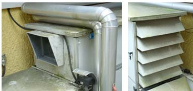
Figura 8-16 – Unidade de tratamento de ar: entrada de ar – insuflação e saída do ar – extração, respectivamente.
