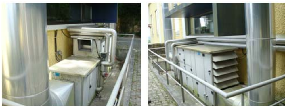
Figura 8-15 – Vistas da Unidade de tratamento de ar.
