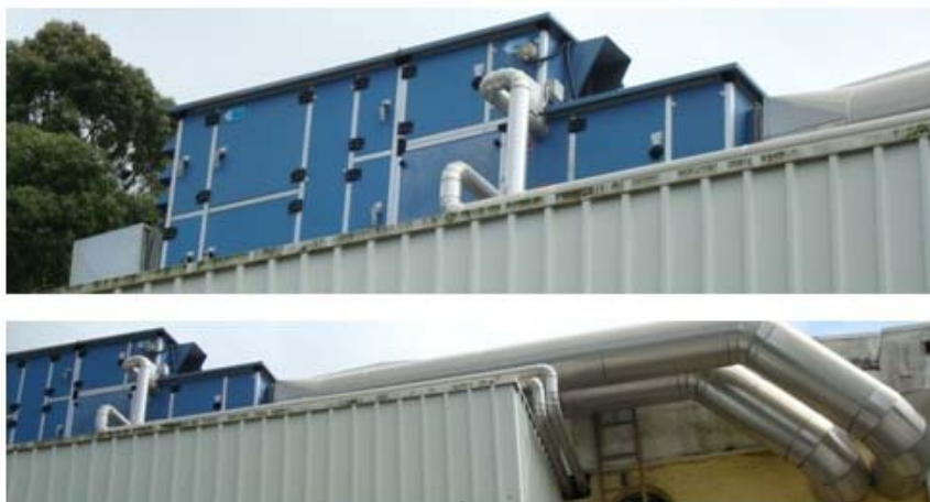
Figura 8-20 – Vista da Unidade de tratamento de ar que alimenta a Mezaninne das Oficinas.
