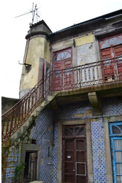
Figura 3.15 - Anomalias da fachada tardoz
