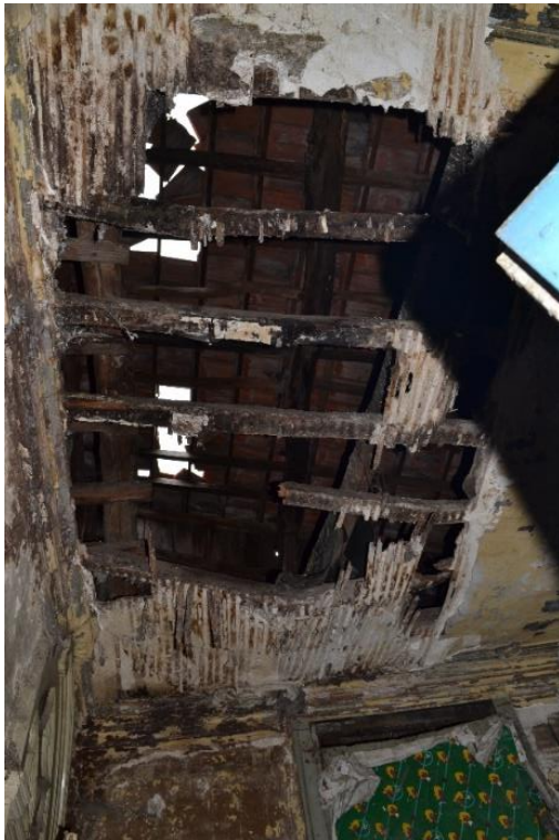
a) Ausência de telhas
