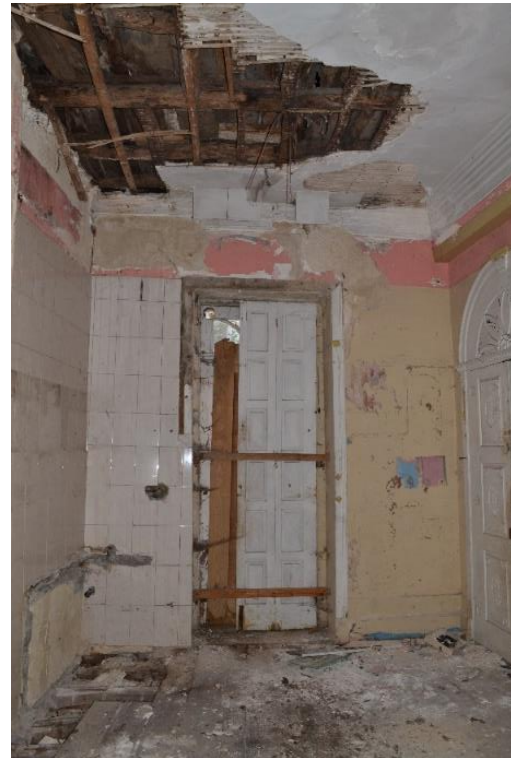
b) Pavimentos danificados
