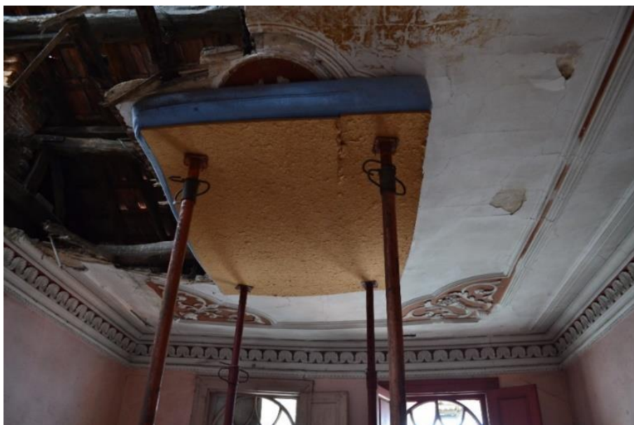
Figura 3.18 - Teto em risco de colapso
