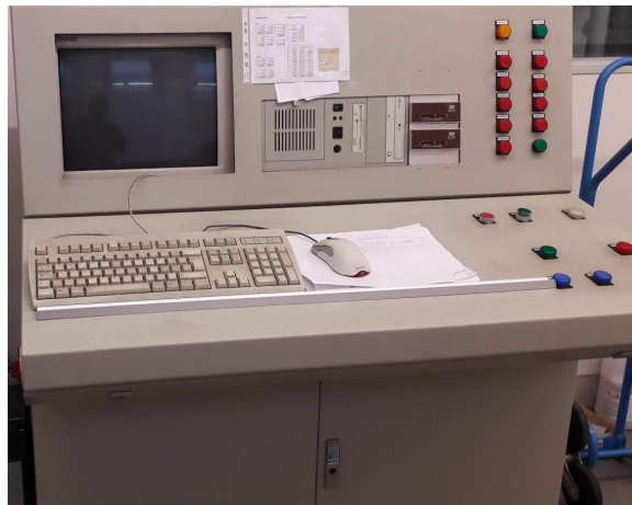
Figura 4.3.: Quadro de controlo.
