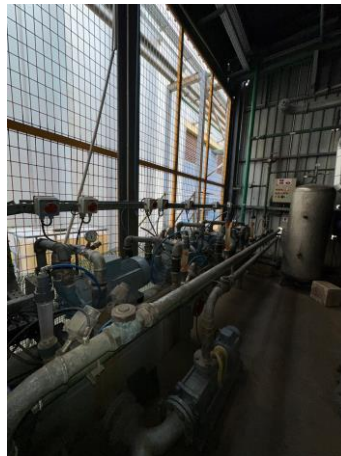
Figura 20 - Central de vácuo instalada na estação técnica.
