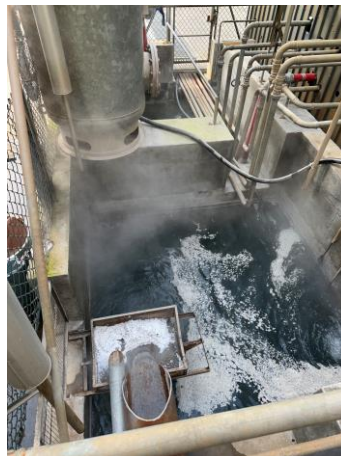
Figura 22 - Tanque de água quente, saída dos condensados.
