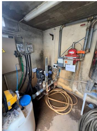
Figura 10 - Bombas balão que equipam a estação de bombagem da Petibol.
