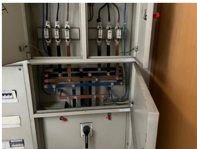
Figura 35 - Quadro de Colunas do edifício
