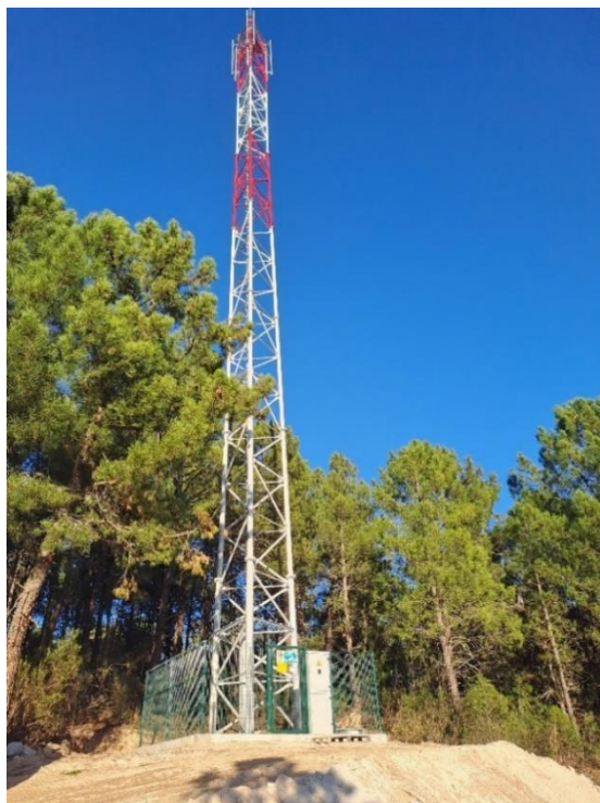
Figura 5 - Estação de telecomunicações
