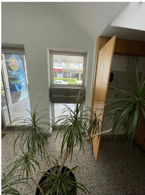
Figura 34 - Posição do Quadro de Colunas no edifício
