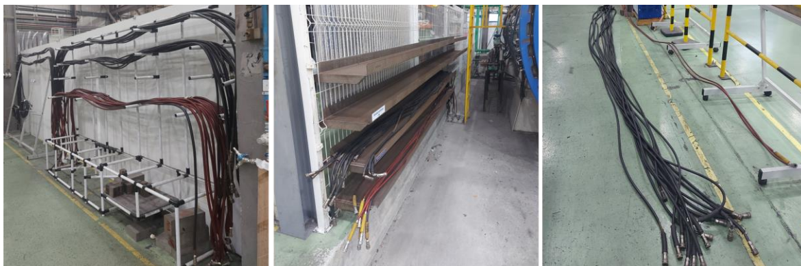
Figura 24 - Situação Atual do armazenamento das mangueiras
