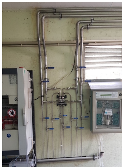
Figura 4.3 - Amostrador automático de 4 válvulas entre os analisadores
