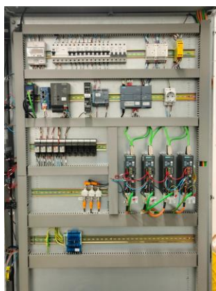
Figura 109 - Quadro elétrico do equipamento.
