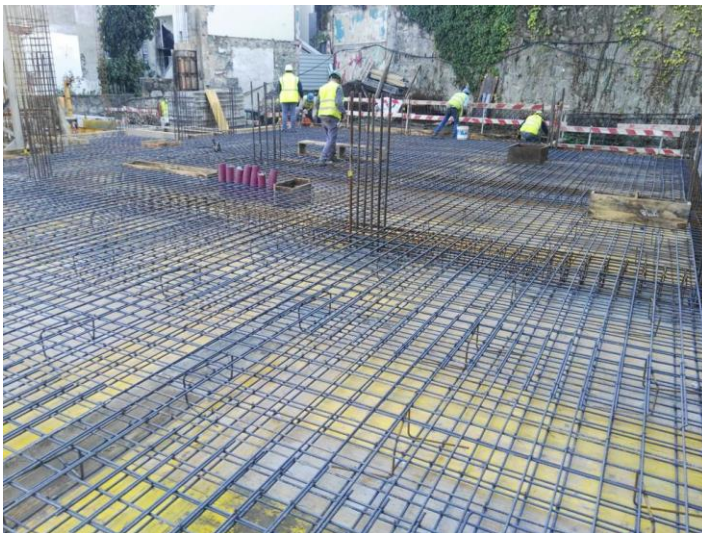
Figura 3 – Trabalhos de armação de ferro de laje de teto (finalização de armação para a betonagem) Fonte de autor
