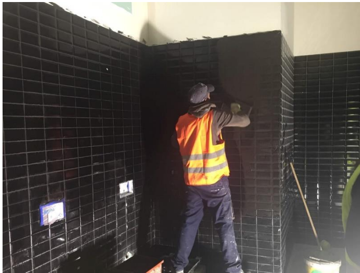
Figura 15 – Aplicação de betume no revestimento cerâmico (trabalhador sem capacete) Fonte de autor
