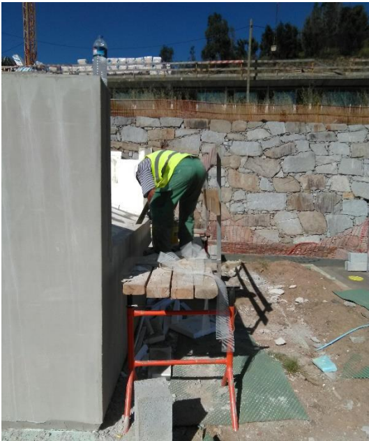
Figura 8 – Reboco do capotto (ausência de acesso adequado à plataforma, de guarda a 15cm, e de prancha adequada) Fonte de autor
