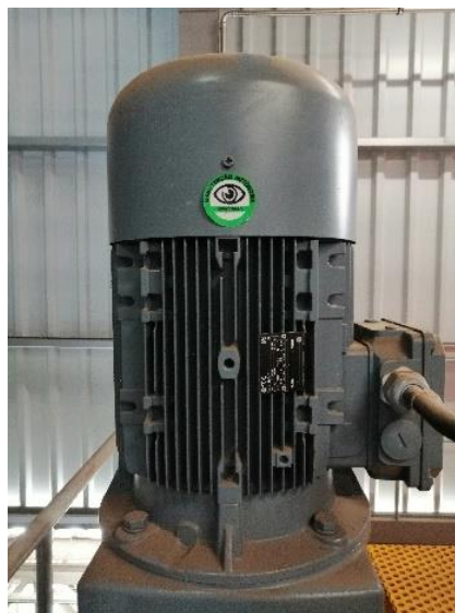
Figura 14 - Colocação da Etiqueta no Equipamento
