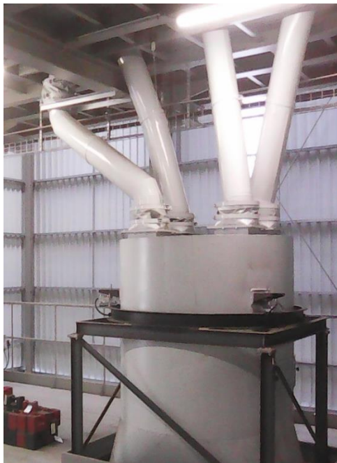
Figura 8 - Tubagem de Ligação entre Silos e Balança
