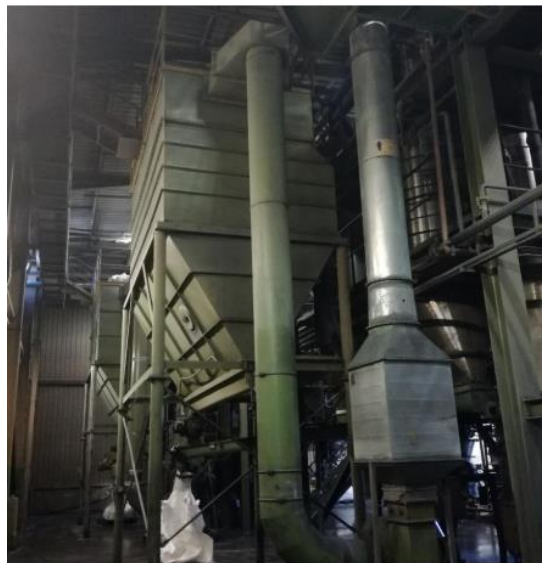
Figura 3.24 - Coletor de aspiração e filtro de mangas (estrutura de cor verde) [7].
