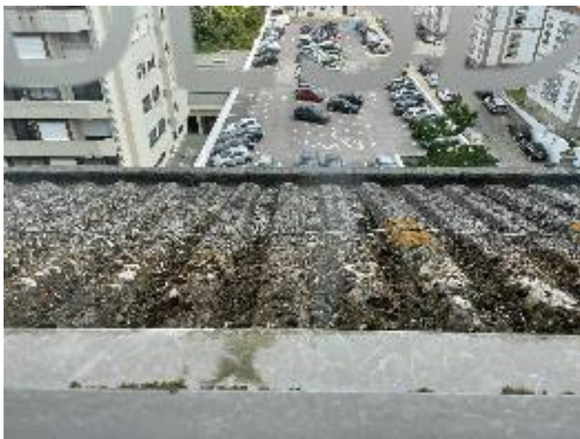
Figura 3.6 - Cobertura em fibrocimento a reabilitar (OMATAPALO - Engenharia e Construção, 2022)
