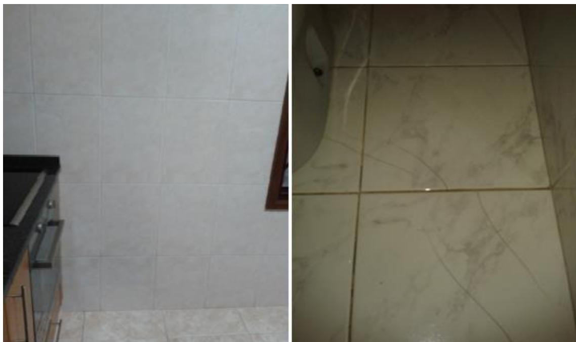
Figura 5.15 – Materiais utilizados na cozinha e estado de conservação do revestimento das instalações sanitárias.
