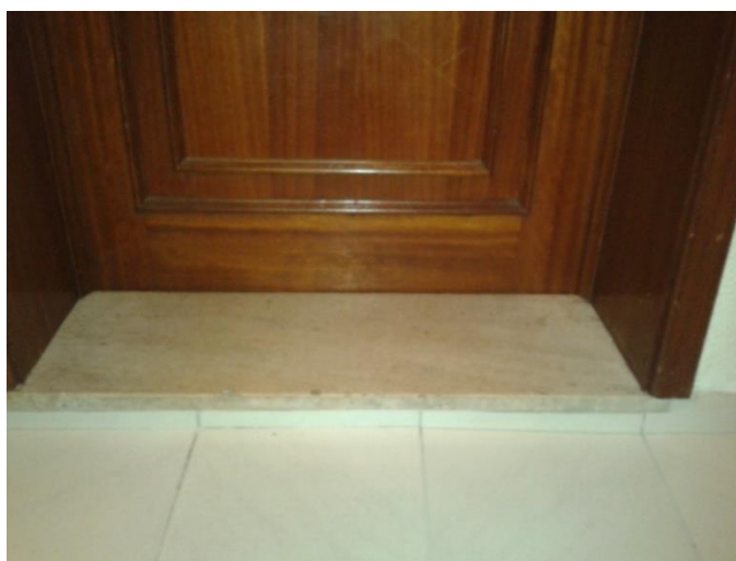
Figura 5.4 – Desnível entre a entrada da habitação e o hall comum.
