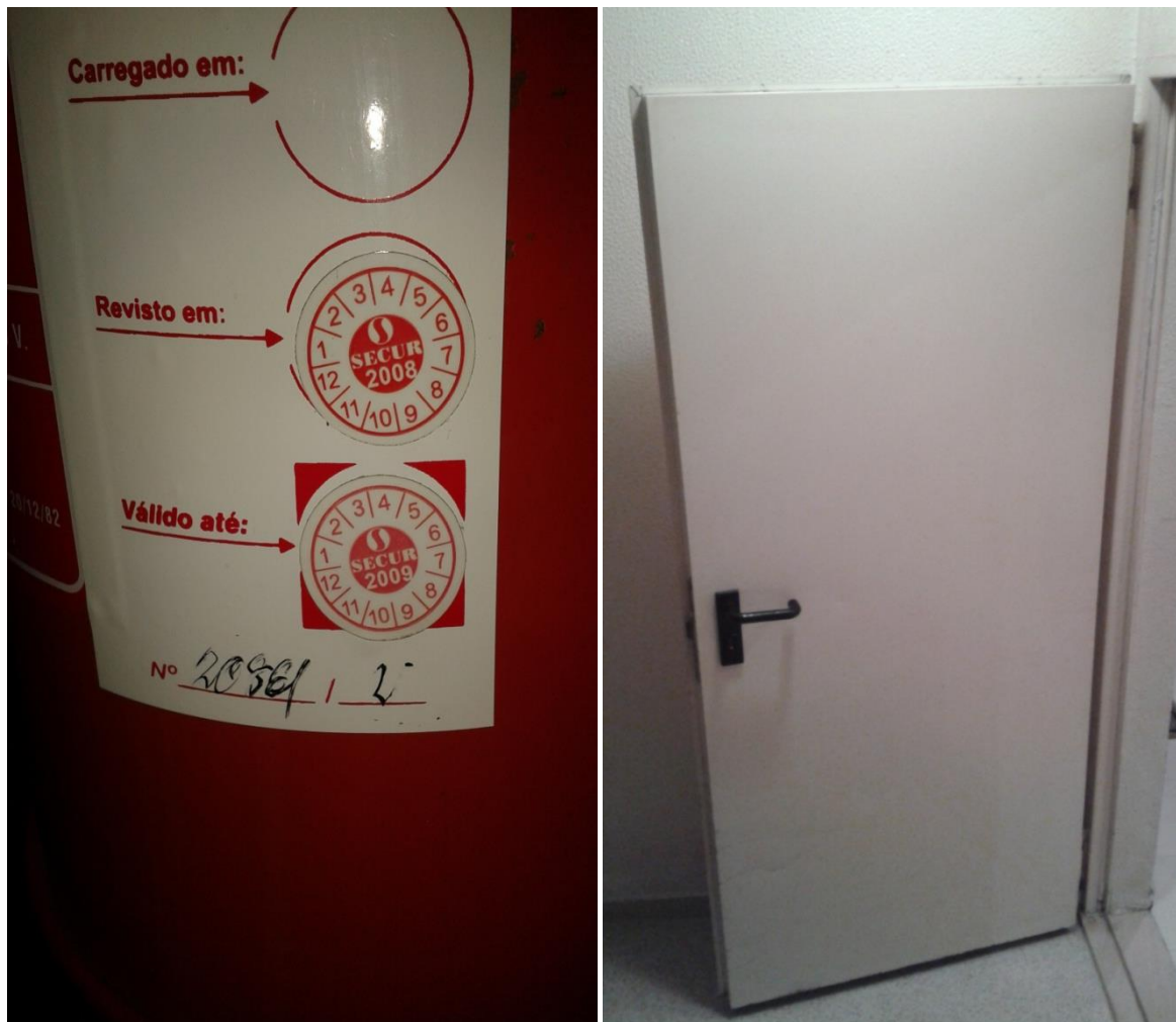
Figura 5.9 – Extintores fora do prazo de validade e porta corta-fogo instalada no edifício.
