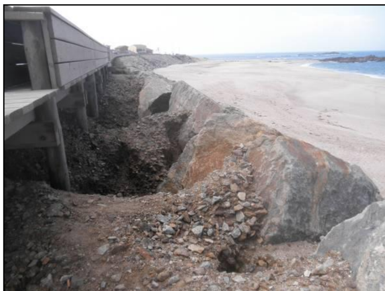
Figura 12 – Infra-escavação por galgamento
