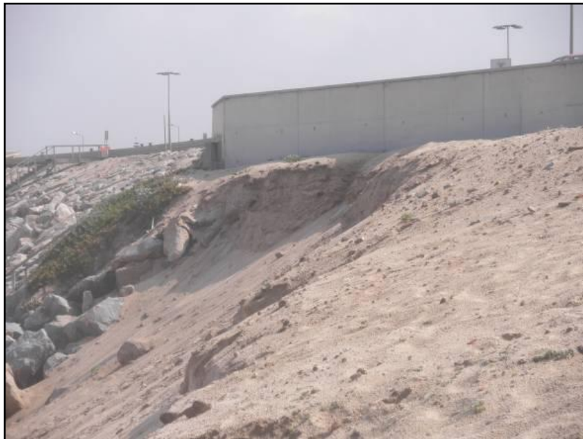
Figura 9 – Infra-escavação na estrutura aderente
