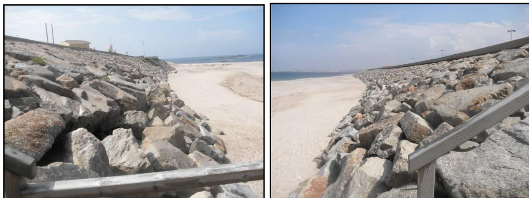
Figura 10 – Danos localizados na estrutura aderente
