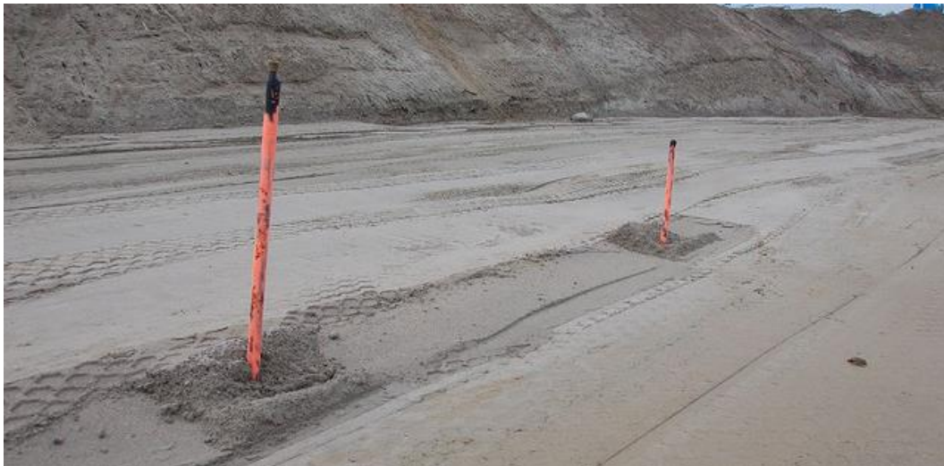
Figura 71 – Exemplo de placas de assentamento instaladas em obra. (Fonte: http://www.flickr.com/ )
