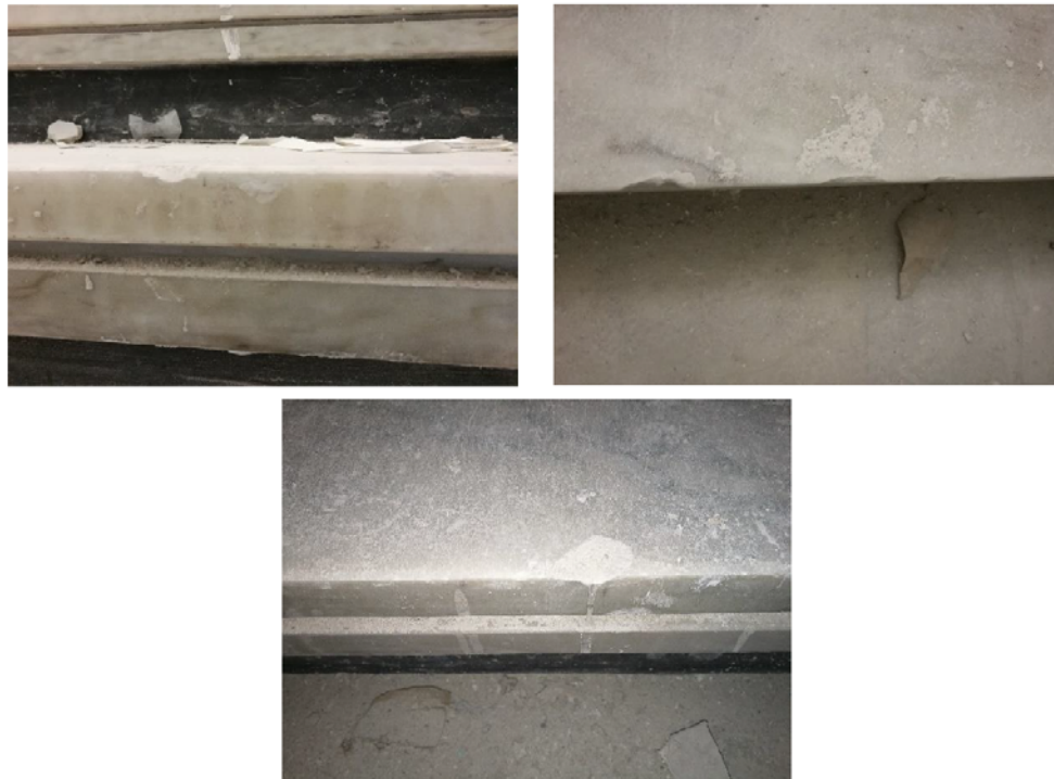
Fig. 3 a 5 – Degraus Danificados
