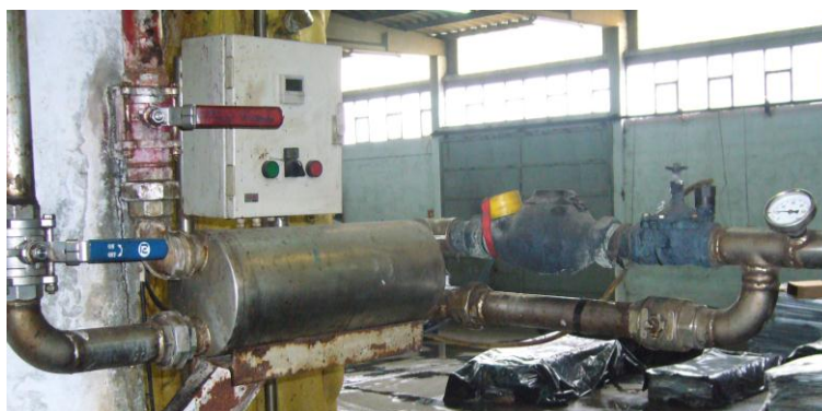
Figura 4.1 - Válvula misturadora e termómetro existentes na empresa Curtumes Aveneda, Lda.
